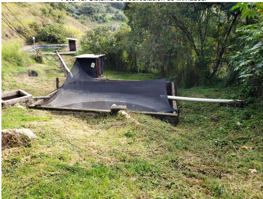
Foto 13. Sistema de recirculación de lixiviados.
