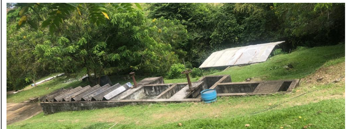
Imagen 39 Sistema de Tratamiento de Aguas Residuales del municipio de Teruel, Huila.
