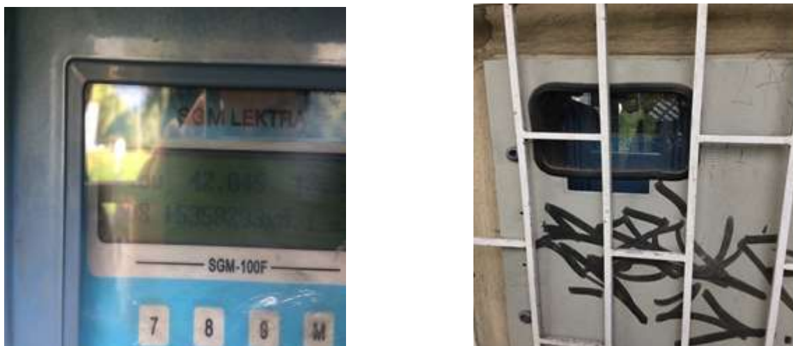
Ilustración 12 Macromedidor EAAB E.S.P.
