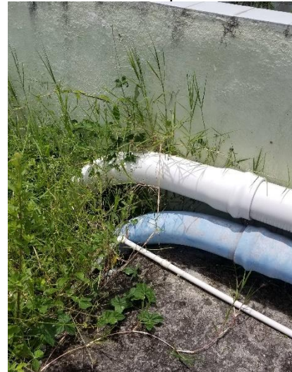
Tubería de dosificación de cloro gaseoso
