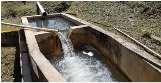
Estructura de entrada, vertedero de medición de caudal y adición de coagulante
