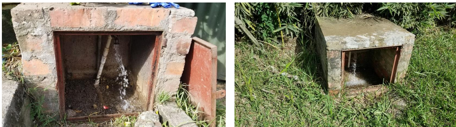
Imagen 12. Puntos de muestreo de calidad del agua en la red de distribución.
