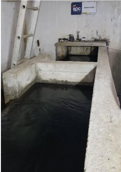
Tanque de contacto de cloro
