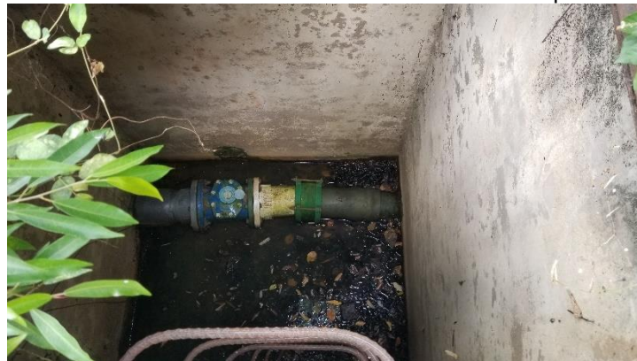
Macromedidor a la salida de la planta
