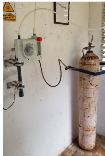
Dosificación de cloro gaseoso
