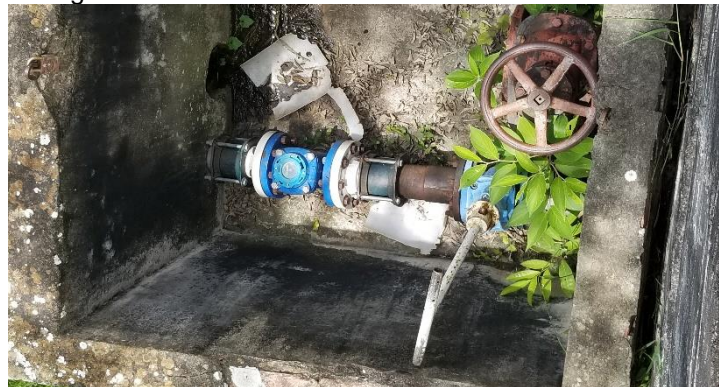
Macromedidor a la salida de la planta
