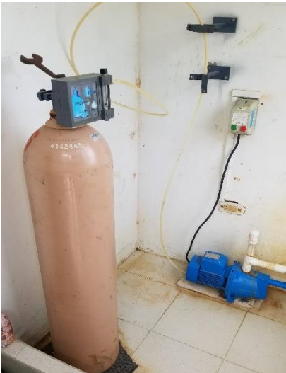
Dosificación de cloro gaseoso
