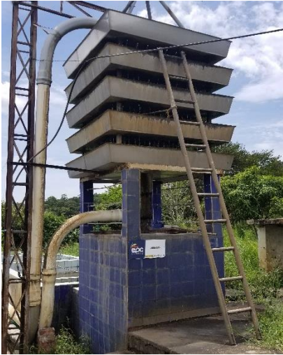
Torre de aireación
