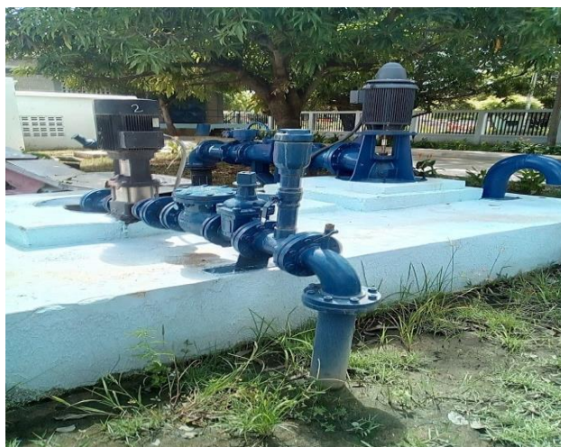
Imagen 39. Sistema de Bombeo
