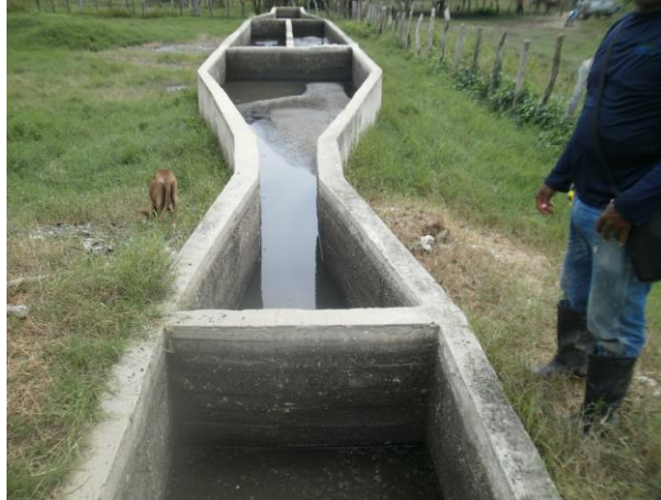
Imagen 83. Estructuras de pre tratamiento de PTAR Manatí
