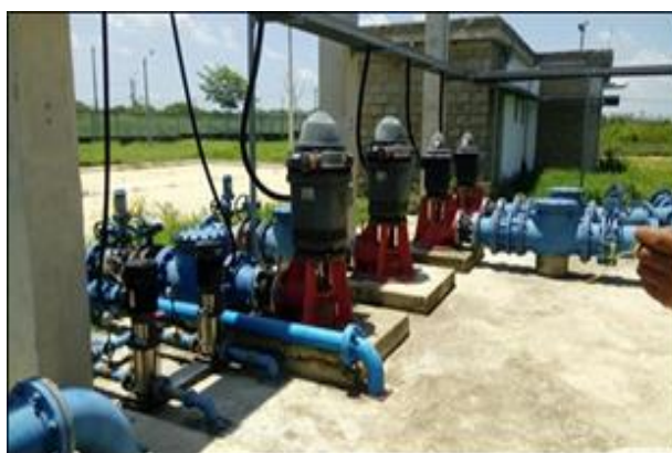
Estación de bombeo de Manatí
