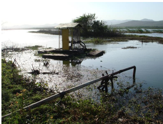
Imagen 54. Estructura de captación. Barcaza Flotante
