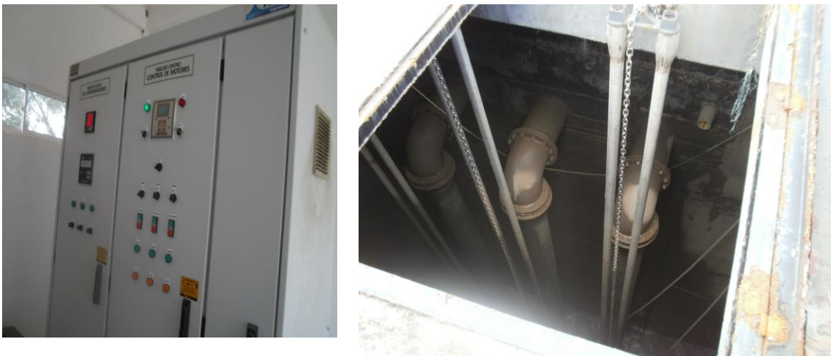
Imagen 85. Pozo húmedo con equipos de bombeo sumergible
