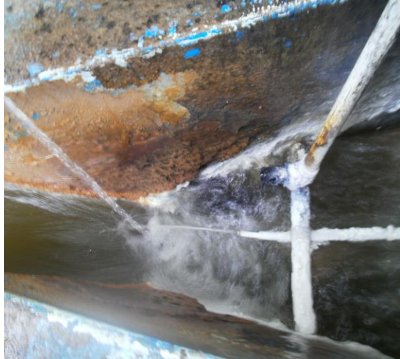
Canaleta Parshall y dosificación de coagulante.
