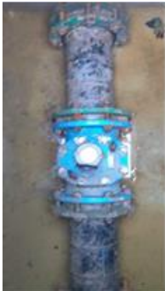
Macromedidor de salida Manatí
