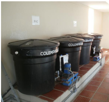
Tanques preparación químicos
