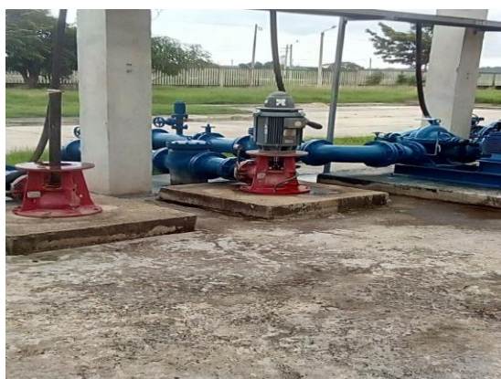
Estación de bombeo de Manatí
