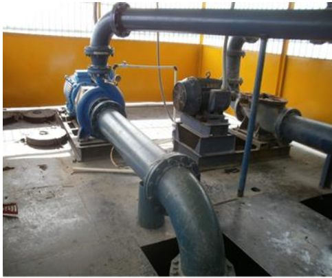
Sistema de bombeo
