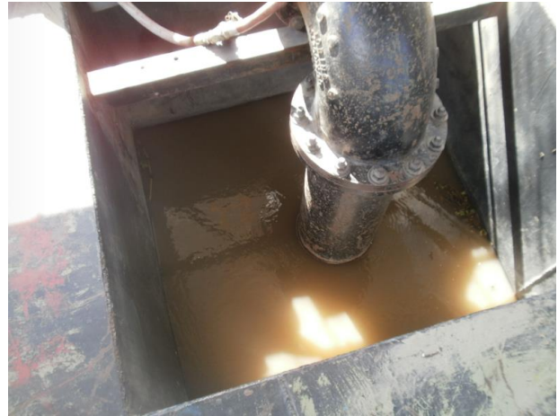
Succión en captación
