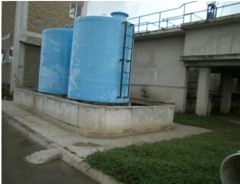
Tanques de almacenamiento de químicos
