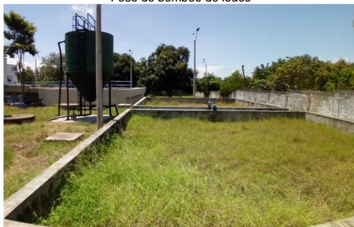
Lecho de secado de lodos
