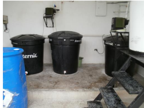
Tanques de mezcla
