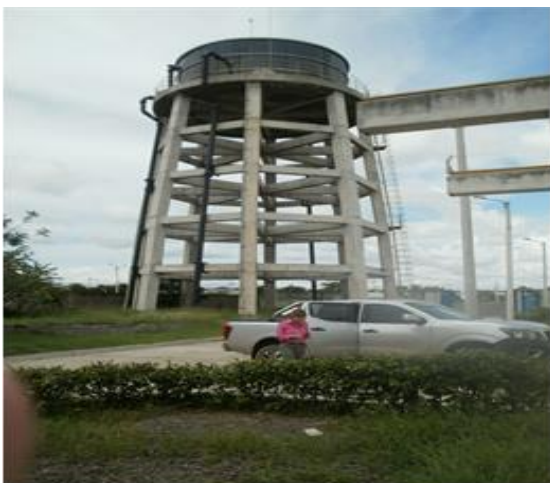
Tanque de almacenamiento de Manatí
