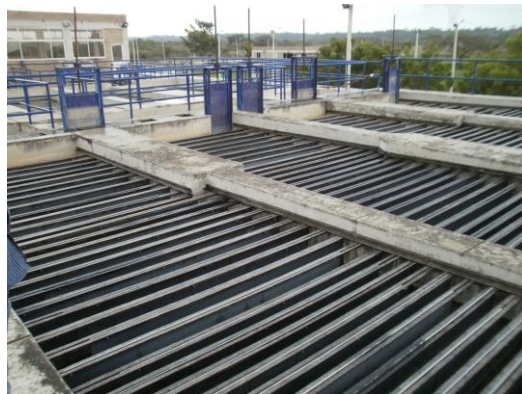
Imagen 15. Módulos de Floculación
