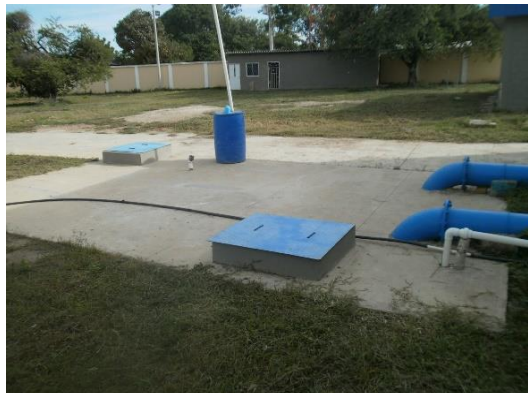
Imagen 48. Tanque subterráneo de cloro
