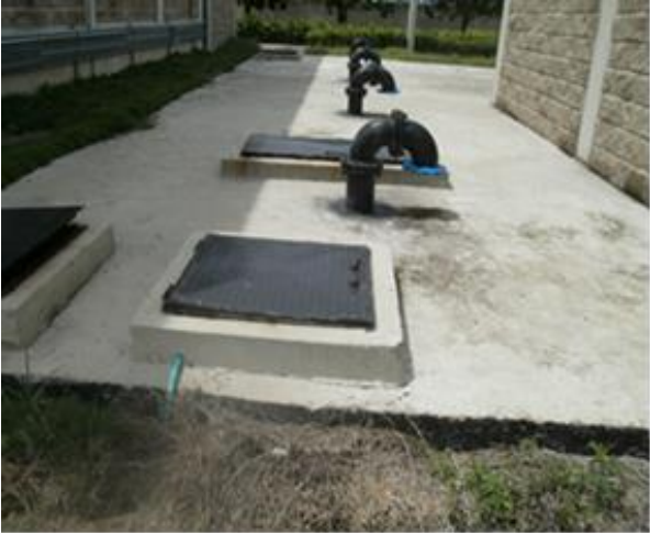
Tanque enterrado cloro
