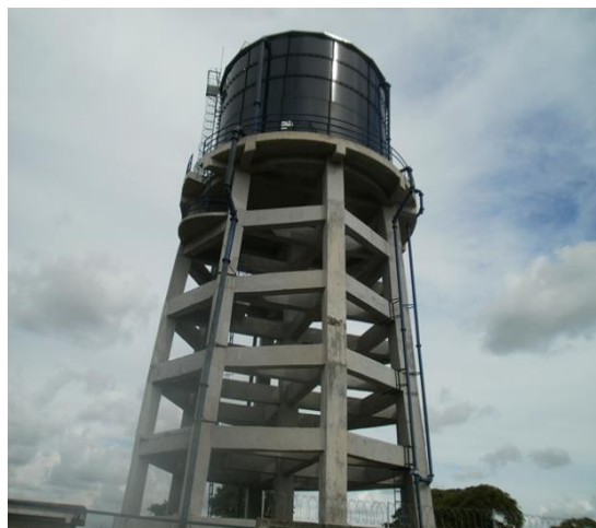
Tanque de almacenamiento de Candelaria
