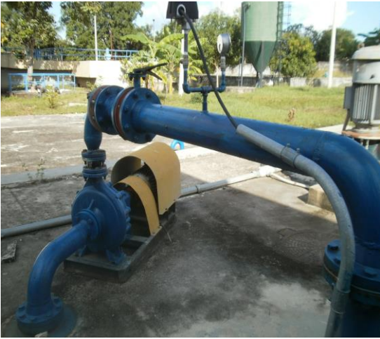
Bombeo agua tratada municipio Santa Lucia
