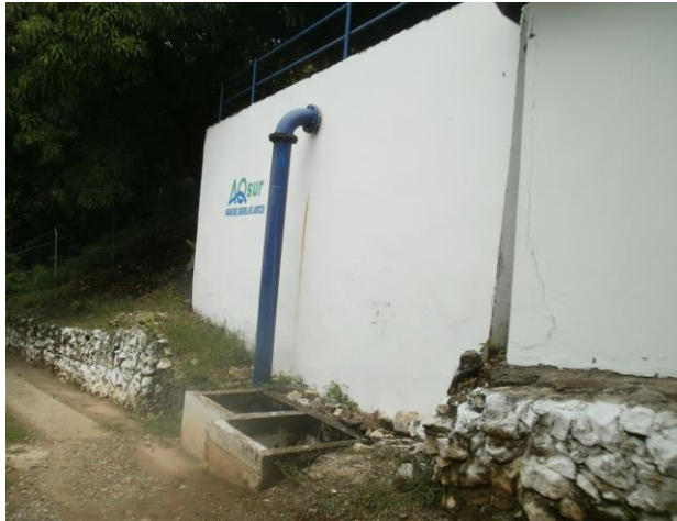
Imagen 80. Tanque de almacenamiento
