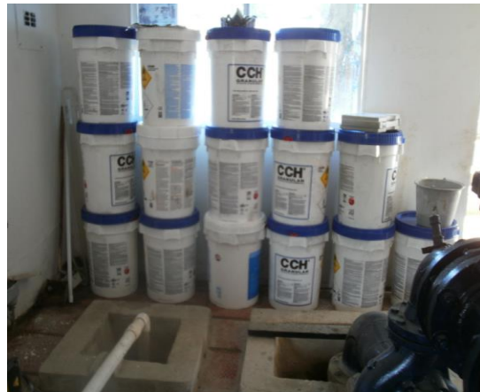
Depósito Hipoclorito de calcio
