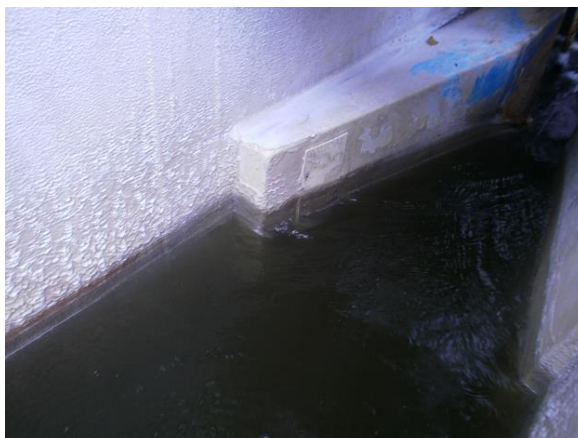
Imagen 73. Cámara de quietamiento
