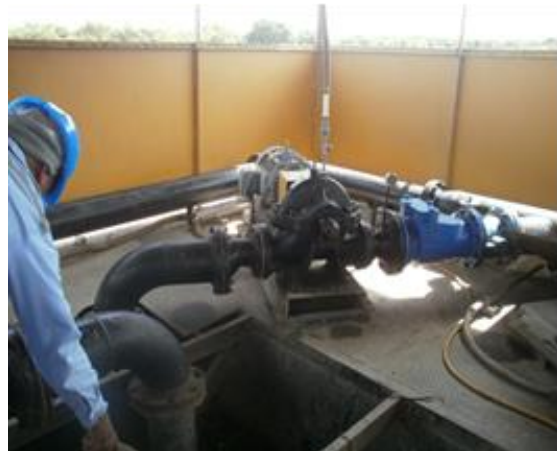
Estación de Bombeo
