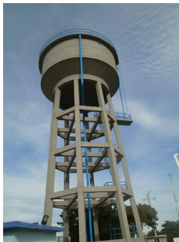
Imagen 51. Tanque de almacenamiento elevado
