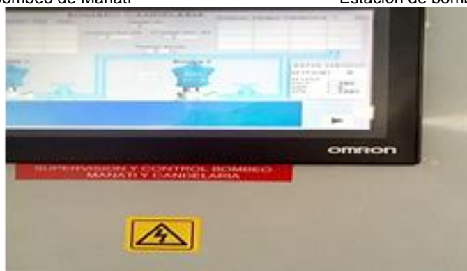
Control automático de bombeo
