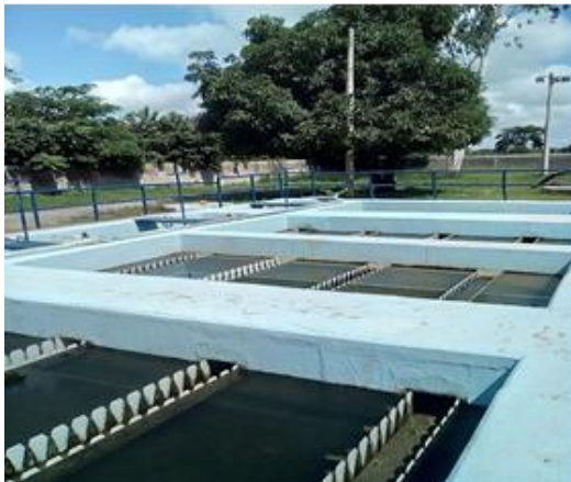
Sedimentadores planta antigua
