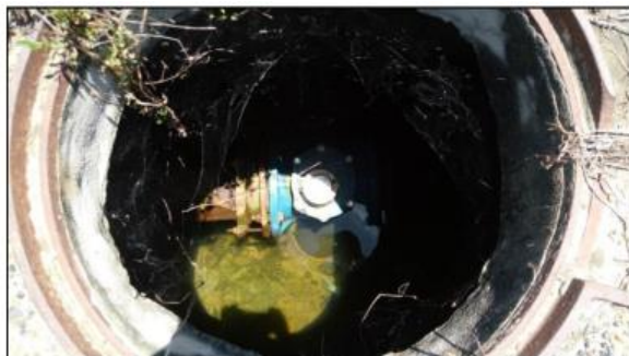
Imagen 61. Macromedidor de 6 pulgadas mecánico tipo Woltman
