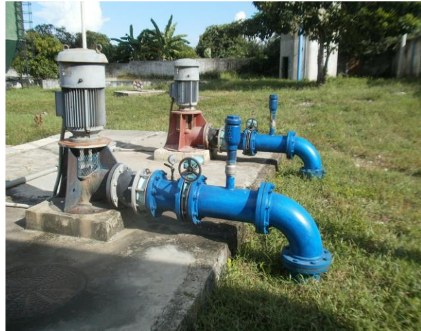
Bombeo agua tratada Corregimiento de algodonol
