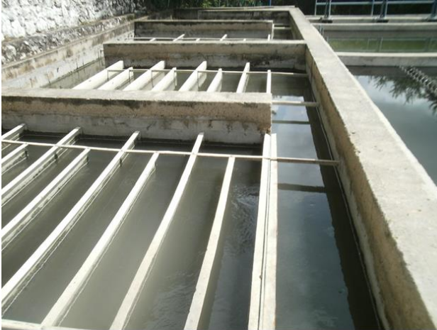
Imagen 76. Planta de tratamiento de agua potable.
