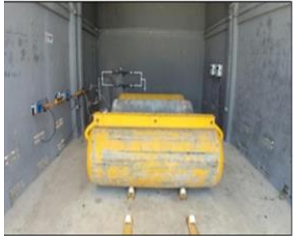
Tanques de cloración
