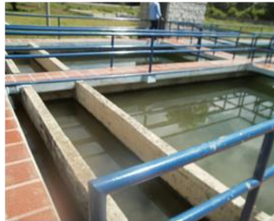
Sedimentadores planta nueva
