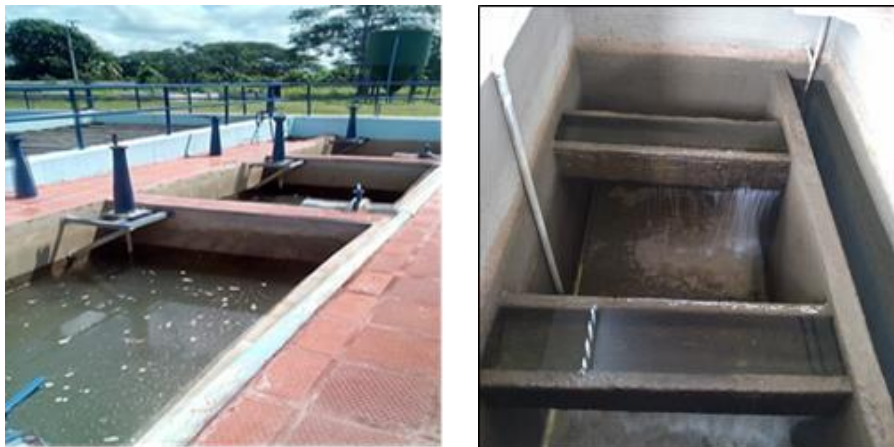
Imagen 35. Filtración planta Campo de La Cruz
