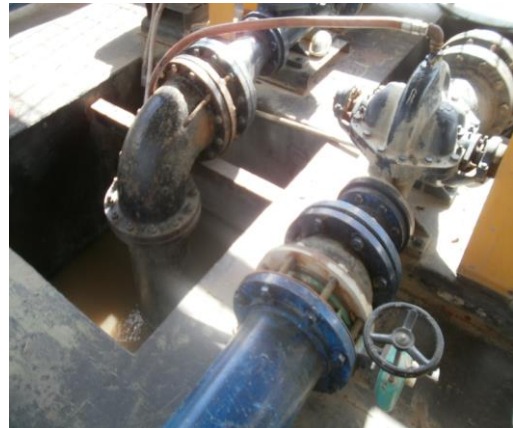
Bombeo de captación
