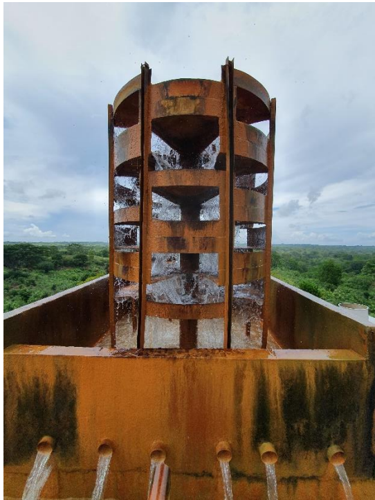
Torre de aireación
