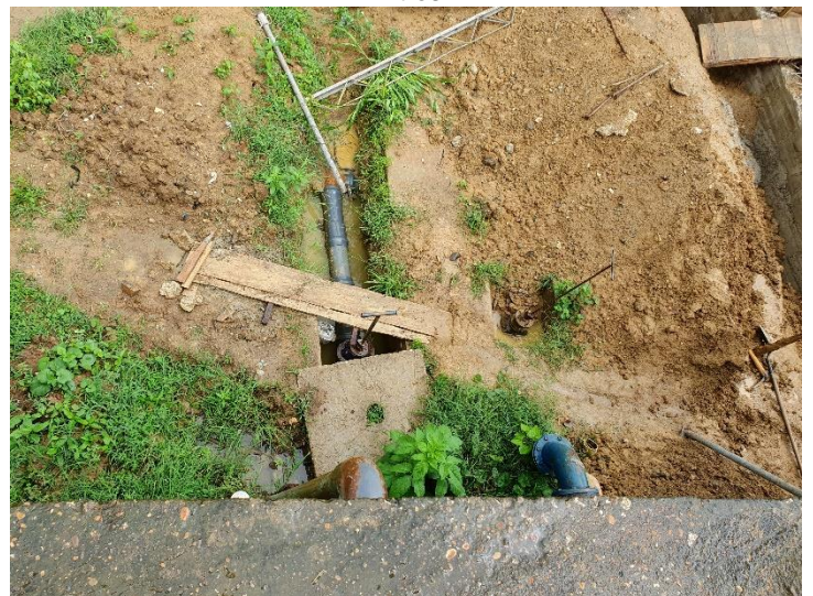
Línea de salida hacia la red de distribución
