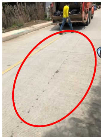
Imagen 13. Trazo de fuga de líquido (lixiviado)
