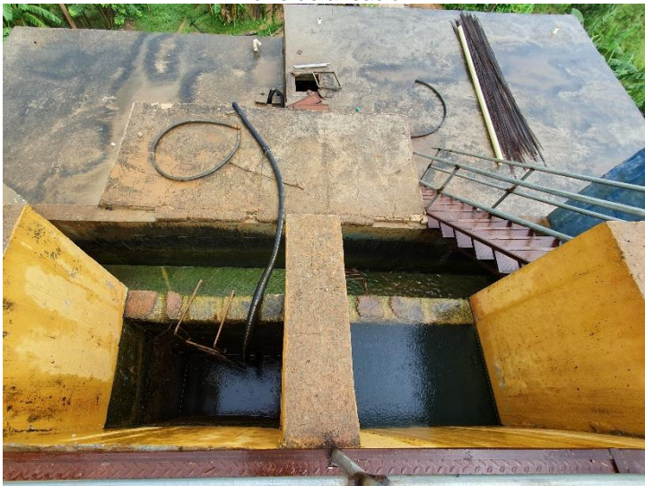
Tanque de almacenamiento
