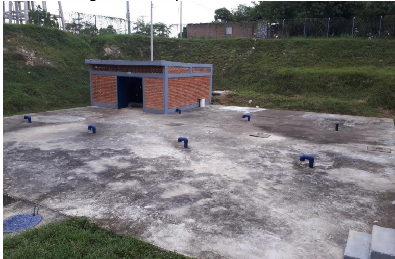
Tanque Subterráneo PTAP
