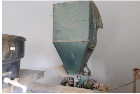
Dosificación Sulfato de aluminio
