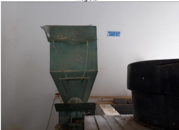
Dosificación Sulfato de aluminio
