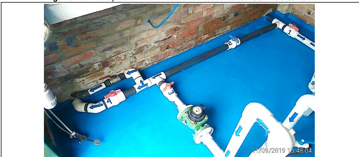
Imagen 9. Elemento para la macromedición de caudales de ACUABOSQUES.
