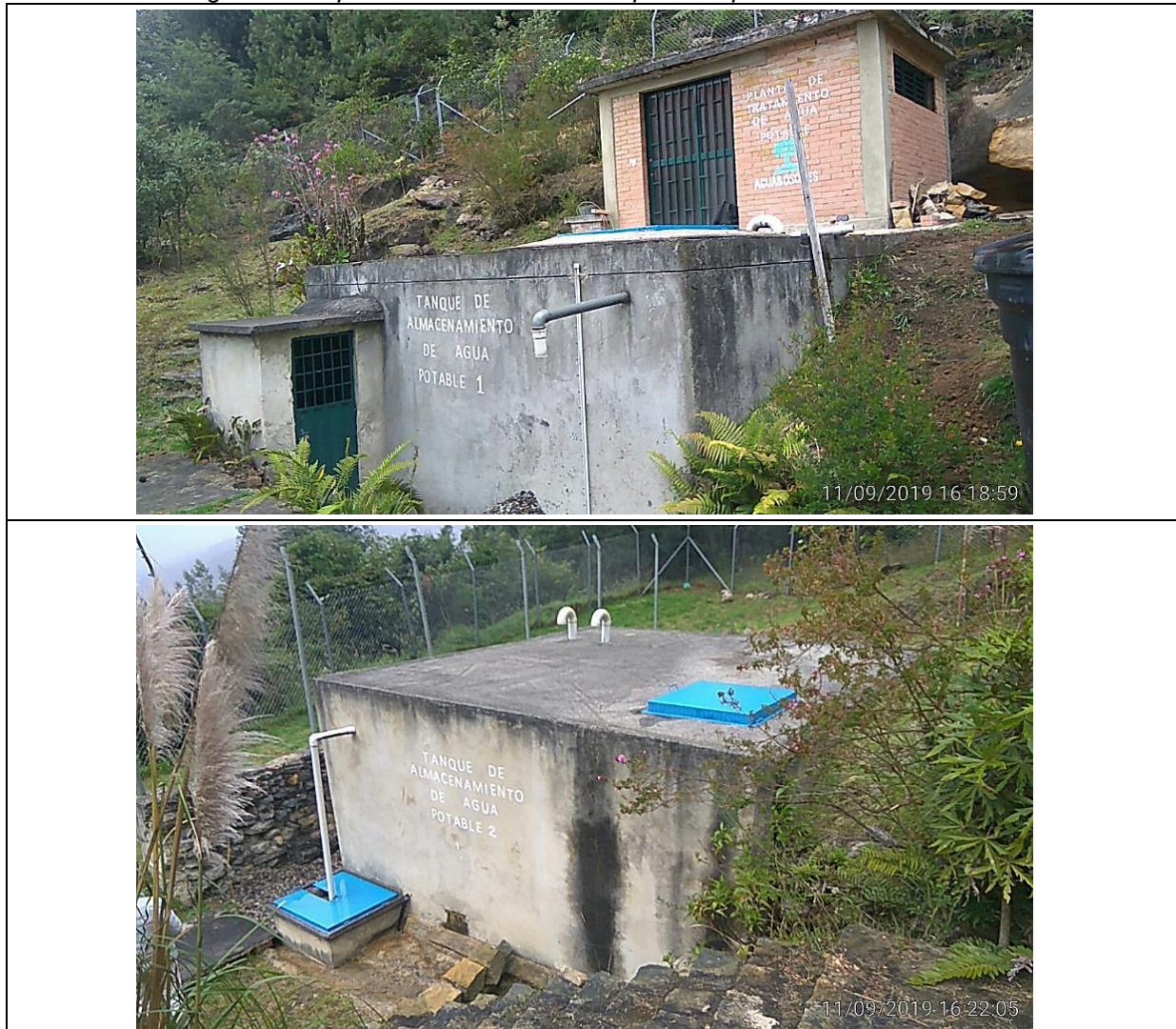
Imagen 8. Tanques de almacenamiento operados por ACUABOSQUES.
