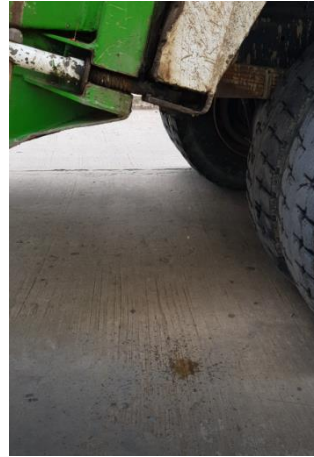
Ref. Fuga de líquido lixiviado
