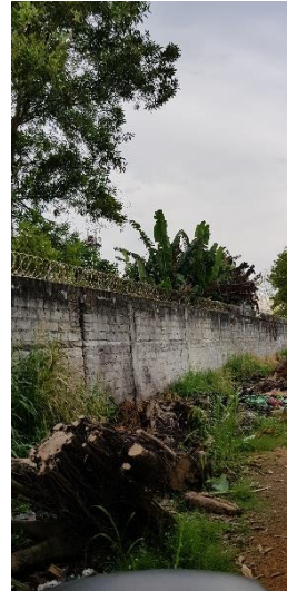
Ref. Punto crítico Calle 6 # 15 Alrededores de la empresa Diabonos
