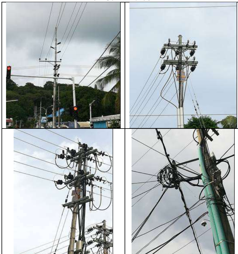
Imagen No. 11. Estado de algunos tramos de Red de Media Tensión y Baja Tensión en San Andrés
