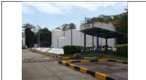
Imagen No. 9. Tanques de almacenamiento de combustible ubicados en la Central de Generación de San Andrés.
