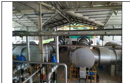
Imagen No. 10. Planta de Generación Residuos Sólidos Urbanos
