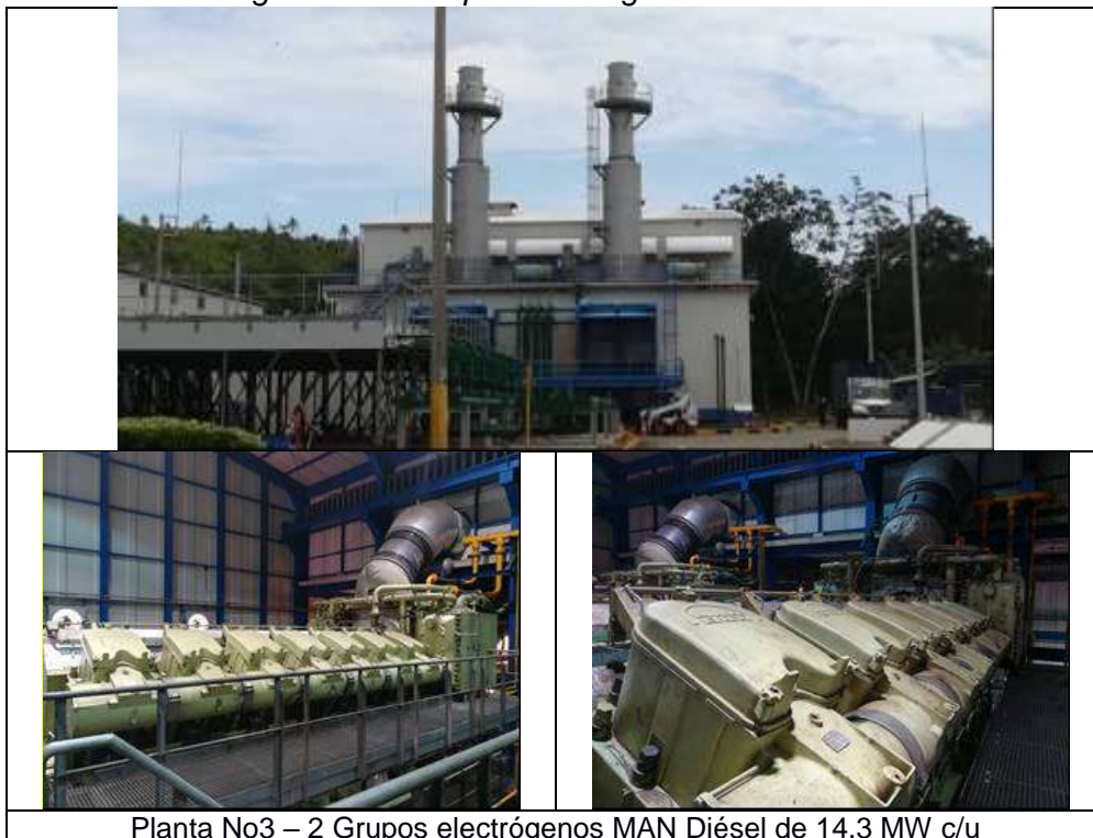
Planta No3 – 2 Grupos electrógenos MAN Diésel de 14,3 MW c/u
