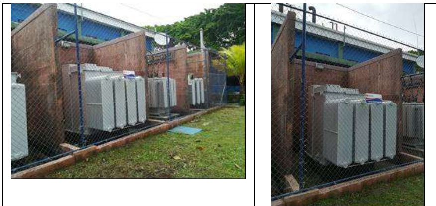
Imagen No. 14. Transformadores elevadores Providencia – SOPESA S.A. ESP
