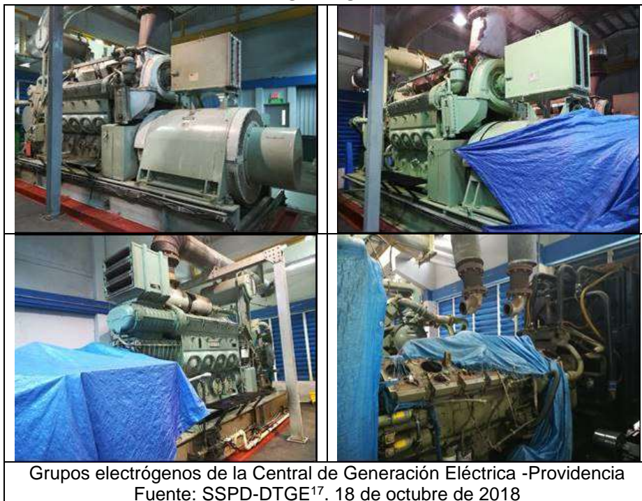
Imagen No. 13. Grupos electrógenos Central de generación Providencia – SOPESA S.A. ESP
