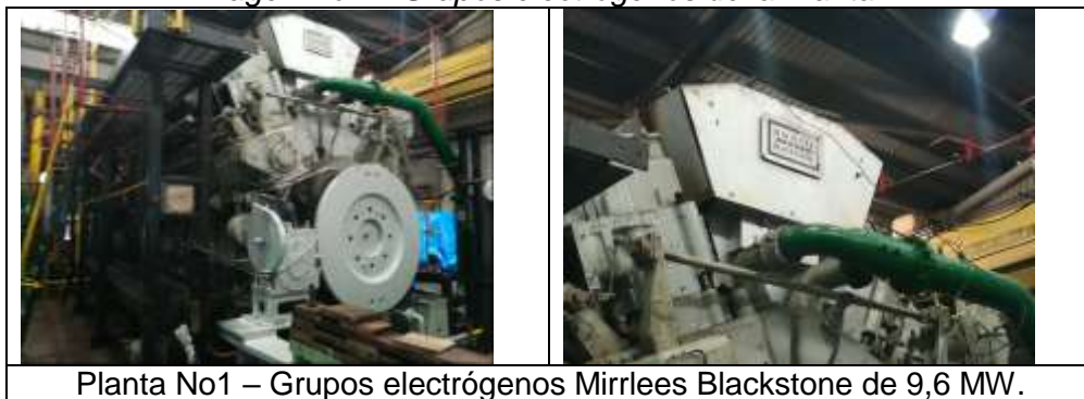
Imagen No. 4. Grupos electrógenos de la Planta 1.
