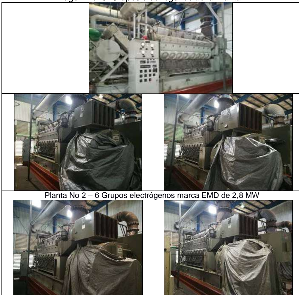
Imagen No. 5. Grupos electrógenos de la Planta 2.
