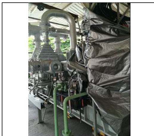
Planta de Residuos Sólidos Urbanos implementada por SOPESA
