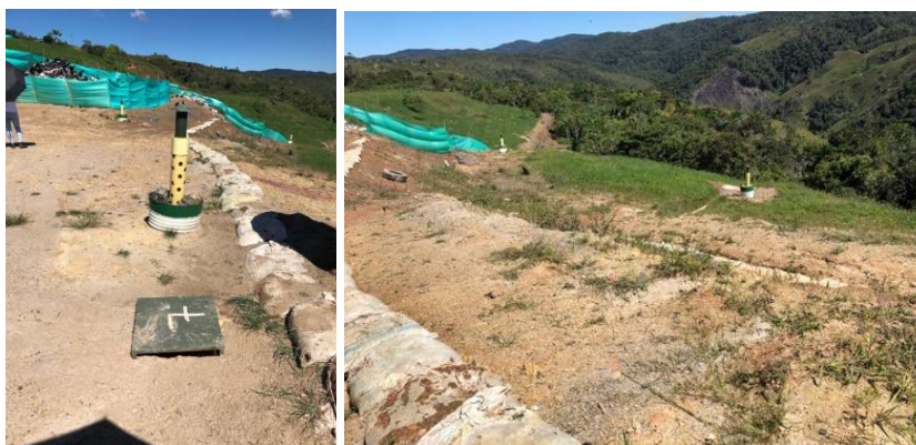
Imagen 61. Chimeneas para evacuación de gases
