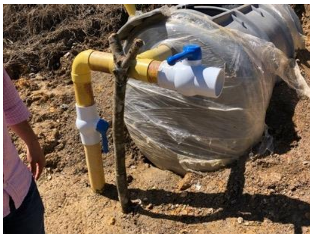
Imagen 55. Tubería de evacuación de lixiviados y de medición de caudales
