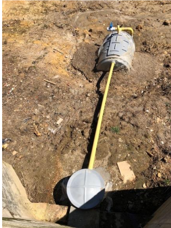
Imagen 51. Tren de tratamiento de lixiviados
