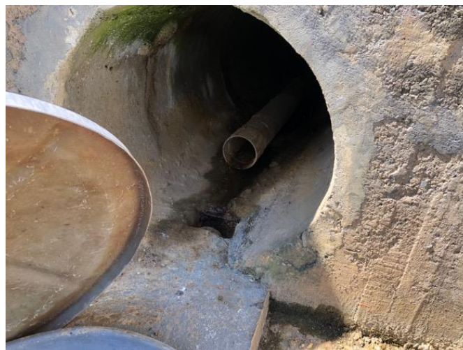
Imagen 52. Tubería de transporte de lixiviados al tren de tratamiento
