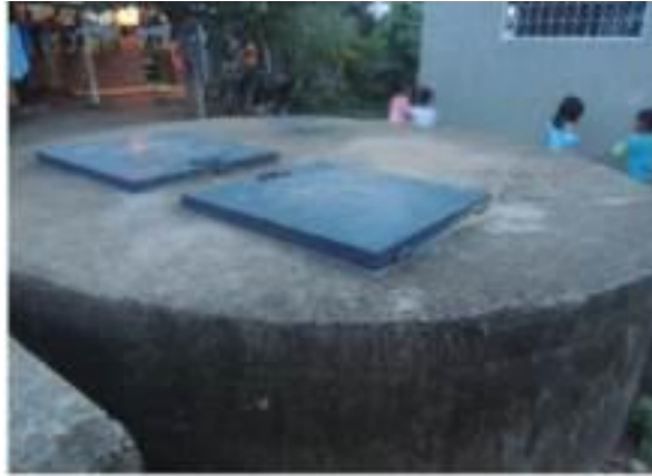
Imagen 27. Estación de bombeo Policarpa
