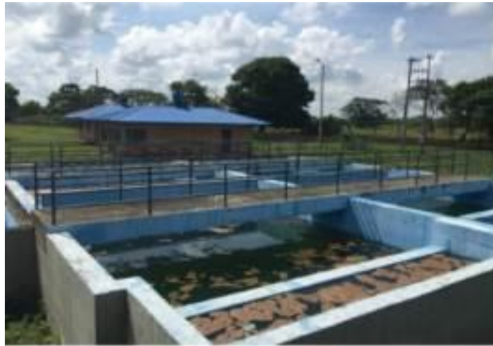
Imagen 31. Tanque de amortiguamiento
