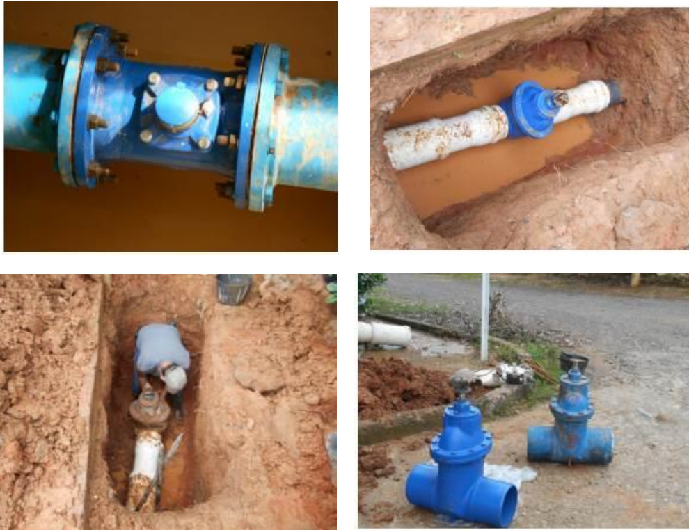
Imagen 20. Soportes mantenimientos red de distribución
