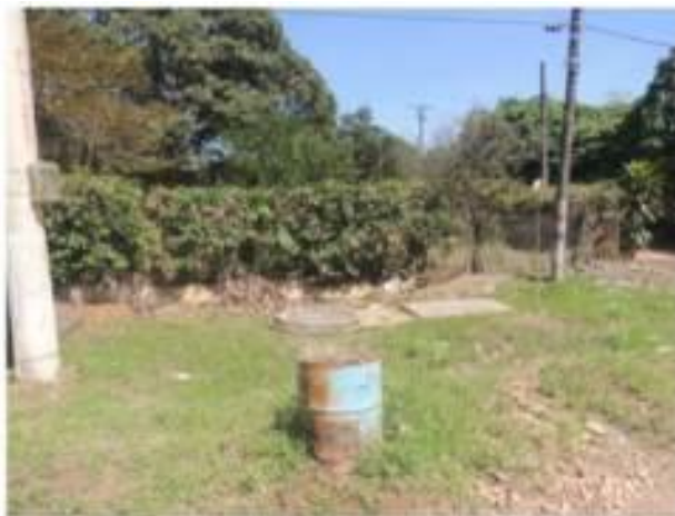
Imagen 28. Estación de bombeo diagonal a Bomberos – Av. Villavicencio
