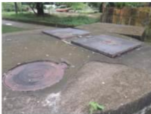
Imagen 26. Estación de bombeo El Muelle – Malecón
