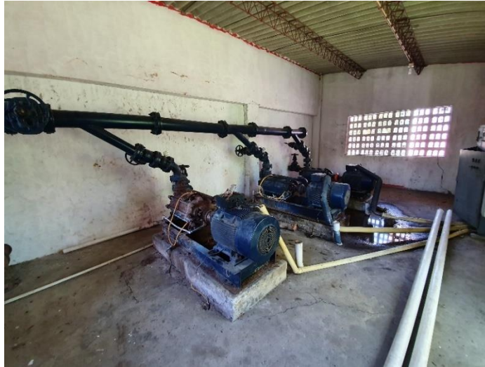
Imagen 5. Estación de bombeo de agua tratada.
