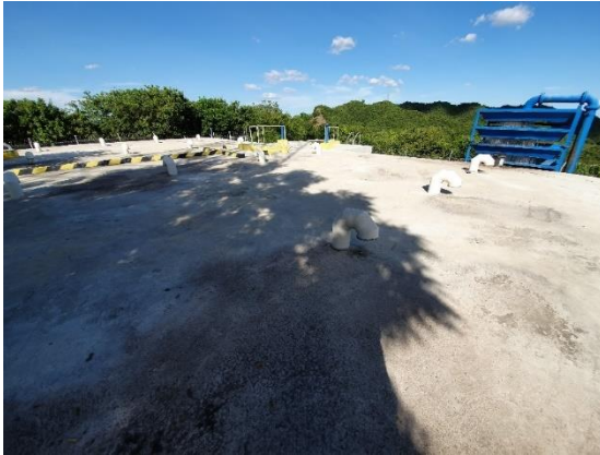
Tanque de cloración
