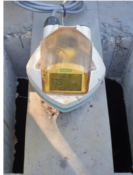
Medidor de nivel del tanque de cloración
