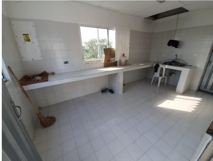
Imagen 8. Cuarto para el laboratorio de control de procesos.
