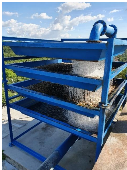
Torre de aireación
