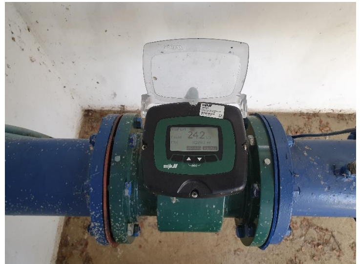
Macromedición del caudal captado
