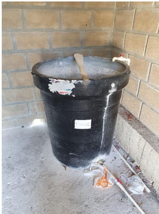
Imagen 4. Tanque de cloración.
