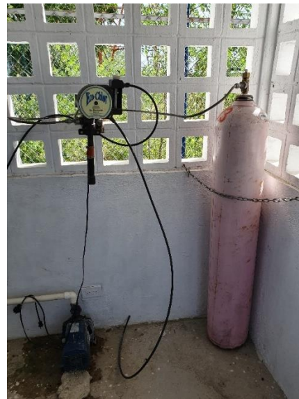
Tanque de cloro gaseoso
