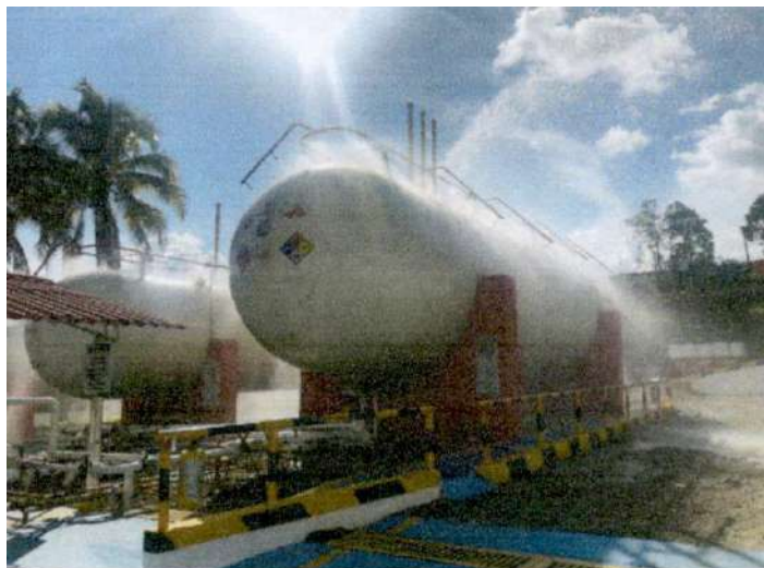
Fuente: GAS CAQUETÁ S.A. E.S.P.
