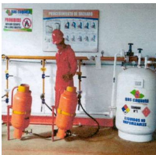
Fuente: GAS CAQUETÁ S.A. E.S.P.
