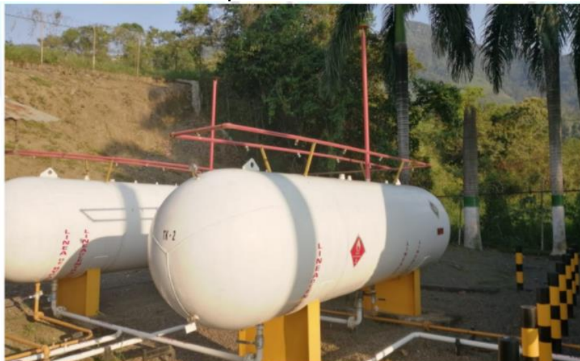
Figura 3 Red contraincendios de la planta Muzo GAS SUPERIOR DE COLOMBIA SA ESP
