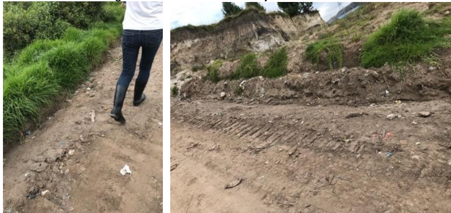
Imagen 51. Sistema de drenaje de escorrentía
