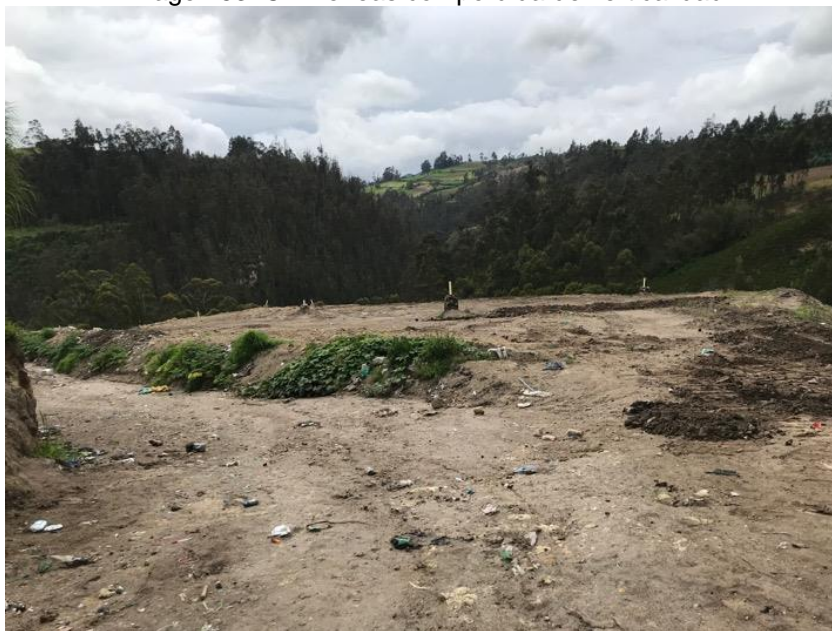
Imagen 53. Chimeneas con pérdida de verticalidad
