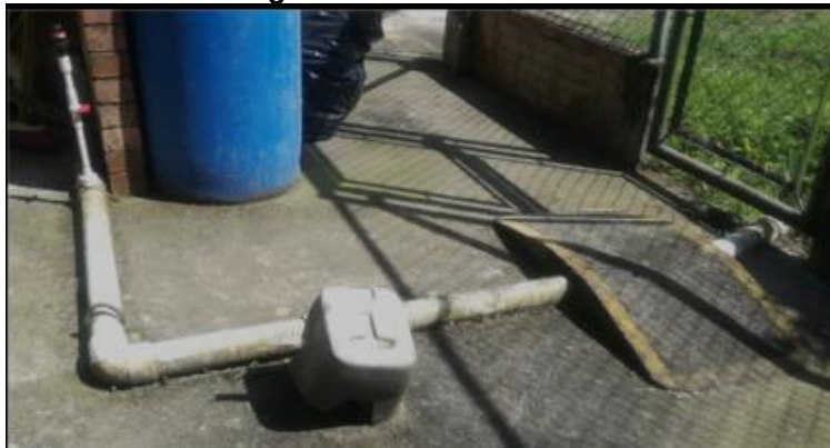
Imagen 2. Línea de aducción 2
