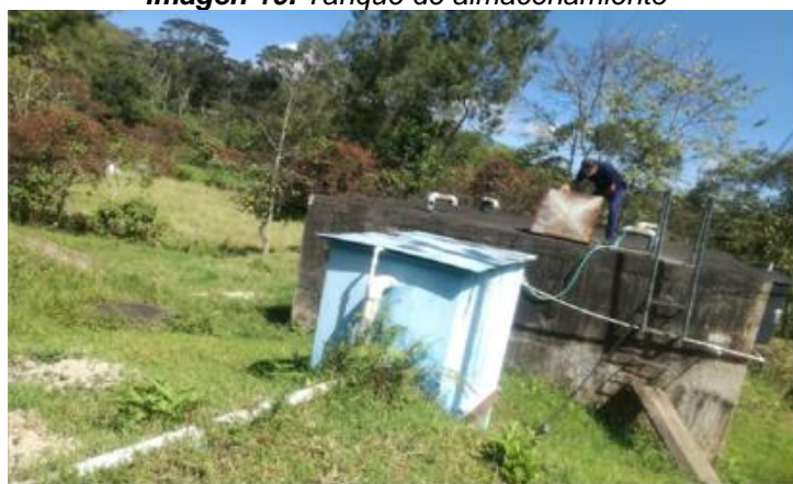
Imagen 19. Tanque de almacenamiento
