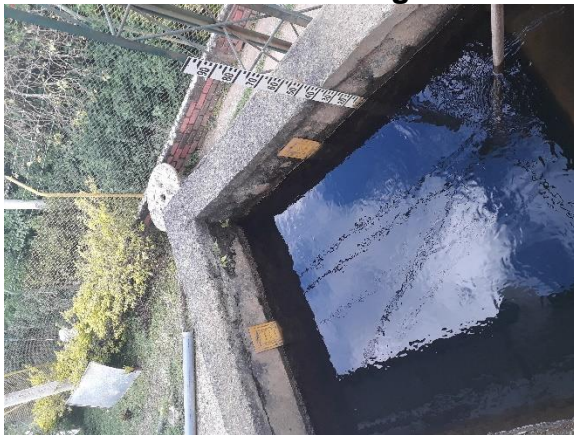
Canal de ingreso y medición de caudal de entrada
