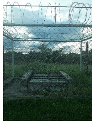
Macromedidor a la salida
