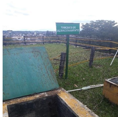
Tanque de almacenamiento
