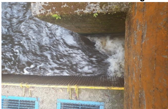
Captación superficial lateral sobre el rio Palace
