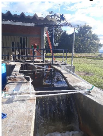
Resalto hidráulico y dosificación coagulante
