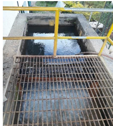
Resalto hidráulico y dosificación de coagulante
