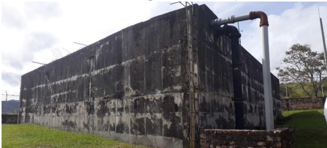
Imagen 10. Tanques de Almacenamiento Popayán
