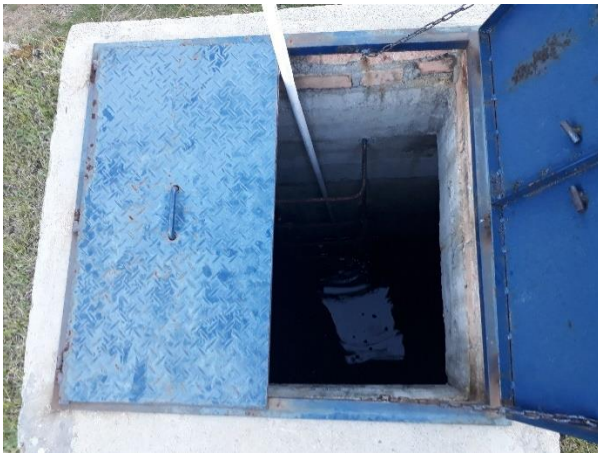
Tanque Contacto Cloro
