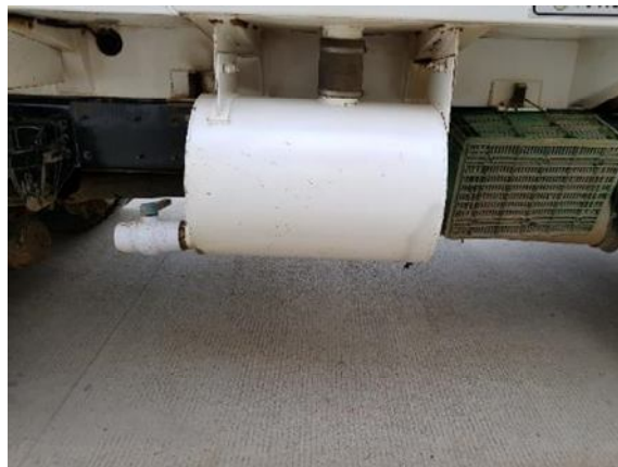
Ref. Tanque de almacenamiento de lixiviados
