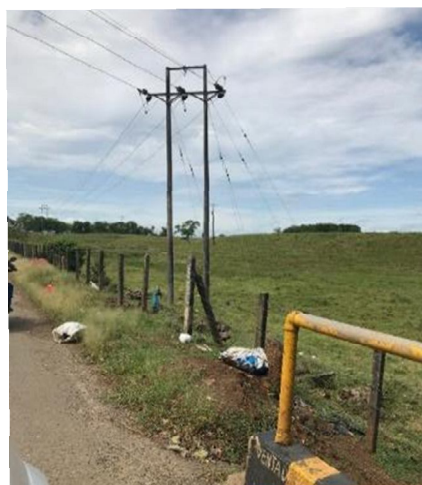
Ref. Punto crítico Vía Puerto Libertador Quebrada Muchajagua
