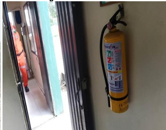
Imagen 42 Extintor en el relleno
