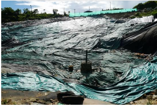
Ilustración 58. Chimenea extracción pasiva. Fuente: Visita de inspección y vigilancia del 18 y 19 de mayo de 2017
