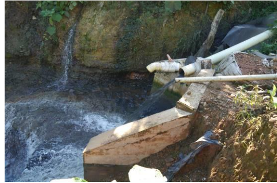
Ilustración 57. Vertimiento de lixiviado tratado. Fuente: Visita de inspección y vigilancia del 18 y 19 de mayo de 2017
