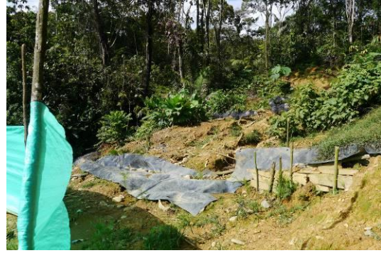
Ilustración 53. Canales perimetrales celda activa. Fuente: Visita de inspección y vigilancia del 18 y 19 de mayo de 2017
