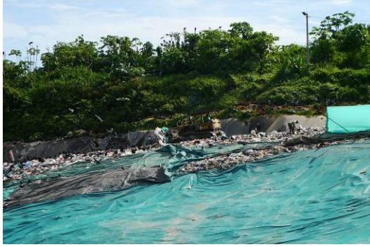
Ilustración 48. Área sin cobertura. Fuente: Visita de inspección y vigilancia del 18 y 19 de mayo de 2017
