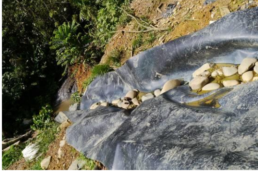
Ilustración 52. Canales perimetrales con residuos. Fuente: Visita de inspección y vigilancia del 18 y 19 de mayo de 2017
