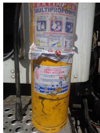
Ilustración 26. Extintor vencido del vehículo TUN 853. Fuente: Visita de inspección y vigilancia del 18 y 19 de mayo de 2017
