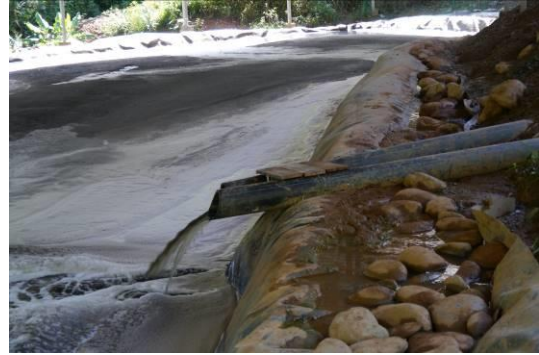
Ilustración 55. Descarga de lixiviado al pondaje. Fuente: Visita de inspección y vigilancia del 18 y 19 de mayo de 2017
