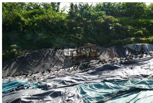
Ilustración 44. Buldócer disgregando y compactando. Fuente: Visita de inspección y vigilancia del 18 y 19 de mayo de 2017
