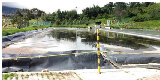
Ilustración 74. Pondajes de la planta de tratamiento de lixiviados. Capacidad total 1998 m 3 . Fuente: Visita de inspección y vigilancia del 30 de junio de 2017
