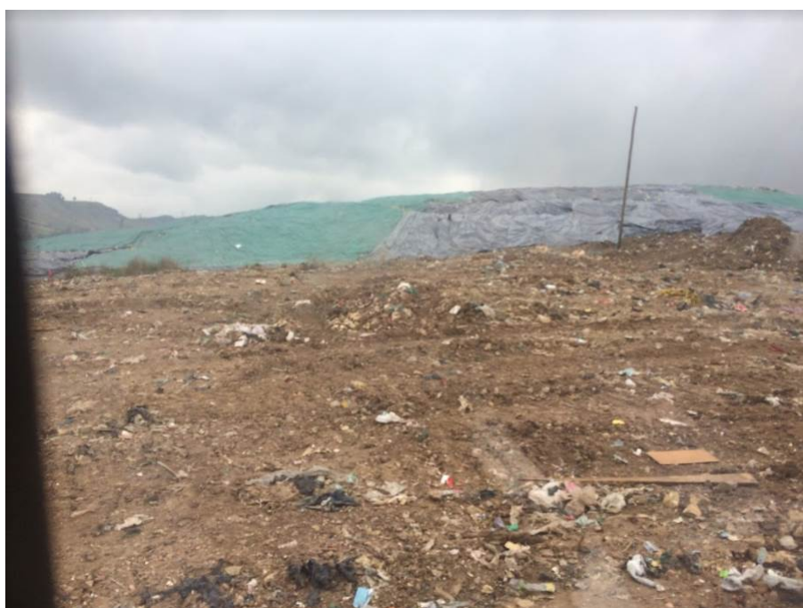
Ilustración 56. Ausencia de cunetas en vía de acceso al frente de trabajo. Fuente: Visita de inspección y vigilancia del 08 de mayo de 2017
