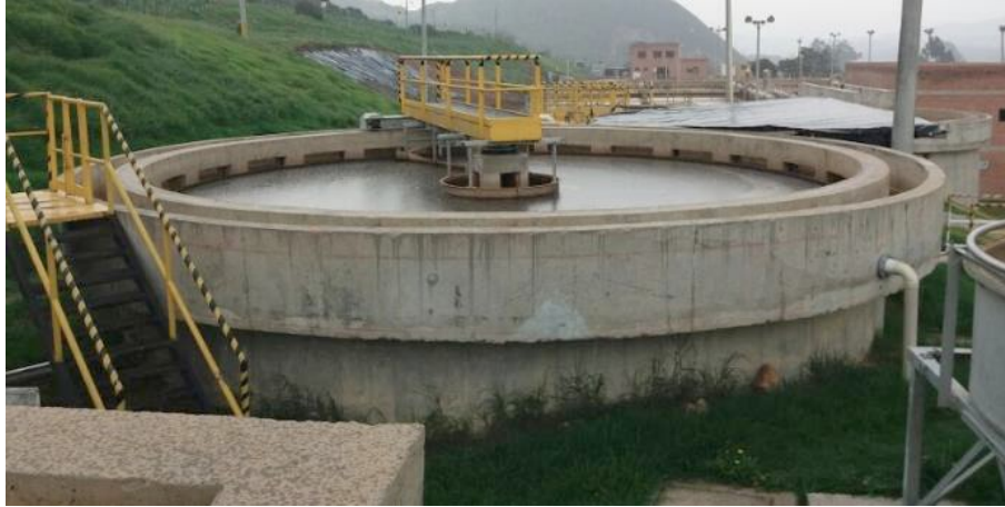
Ilustración 65. Decantador. Fuente: Visita de inspección y vigilancia del 30 de junio de 2017.
