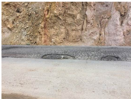
Ilustración 7. Fallas estructurales de la capa asfáltica
