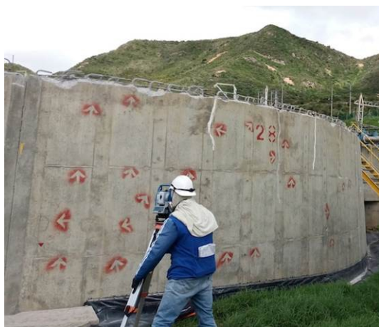
Ilustración 71. Obras de reforzamiento estructural en biorreactores. Fuente: Visita de inspección y vigilancia del 30 de junio de 2017
