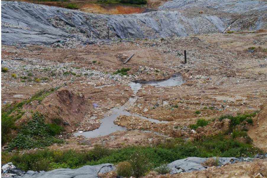
Ilustración 48. Flujos de lixiviados en zona del deslizamiento. Fuente: Visita de inspección y vigilancia del 08 de mayo de 2017
