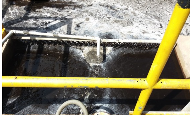
Ilustración 62. Adición de coagulantes. Fuente: Visita de inspección y vigilancia del 30 de junio de 2017.
