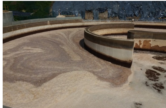
Ilustración 67. Biorreactores. Fuente: Visita de inspección y vigilancia del 30 de junio de 2017.
