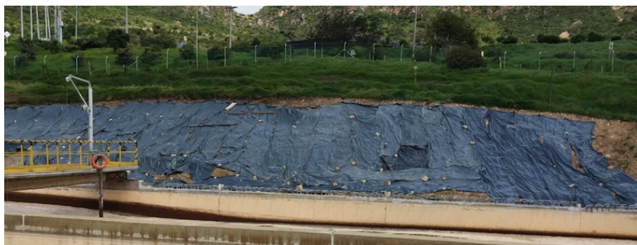
Ilustración 73. Construcción de muro de contención. Fuente: Visita de inspección y vigilancia del 30 de junio de 2017
