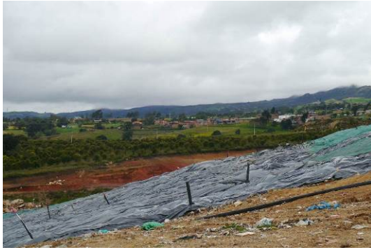
Ilustración 83. Chimeneas que han perdido su posición vertical. Fuente: Visita de inspección y vigilancia del 08 de mayo de 2017
