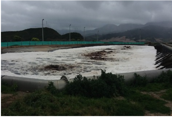
Ilustración 68. Estructuras SBR. Fuente: Visita de inspección y vigilancia del 30 de junio de 2017.
