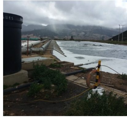
Ilustración 69. Estructuras SBR. Fuente: Visita de inspección y vigilancia del 30 de junio de 2017.
