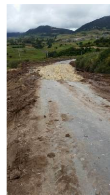
Ilustración 15. Intervención de vía de aproximación al frente de trabajo. Fuente: Visita de inspección y vigilancia del 11 de agosto de 2017
