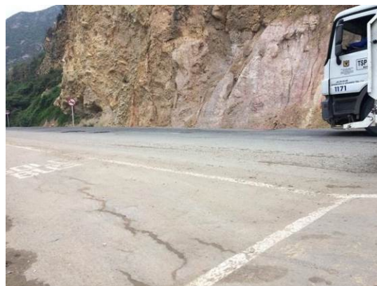
Ilustración 8. Fallas estructurales de la capa asfáltica
