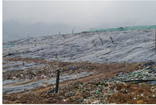
Ilustración 84. Chimeneas que han perdido su posición vertical. Fuente: Visita de inspección y vigilancia del 08 de mayo de 2017
