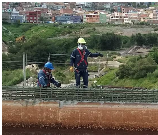
Ilustración 72. Obras de reforzamiento estructural en biorreactores. Fuente: Visita de inspección y vigilancia del 30 de junio de 2017
