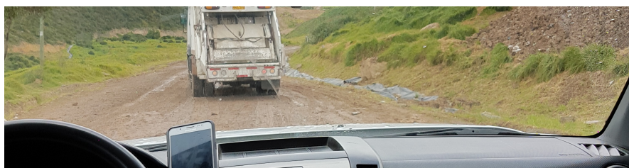
Ilustración 57. Ausencia de cunetas a ambos lados de la vía. Fuente: Visita de inspección y vigilancia del 06 de julio de 2017
