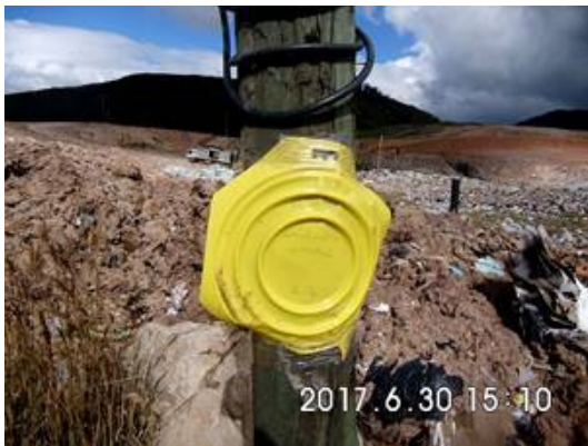
Ilustración 41. Instalación de platillo de monitoreo en el costado norte Terraza Optimización Fase II, Fuente: UNIÓN TEMPORAL INTER DJ
