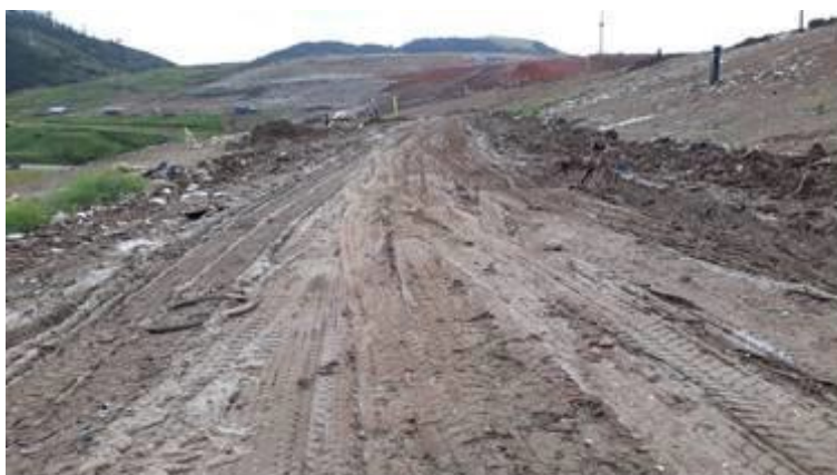
Ilustración 11. Ausencia de sistema de drenaje aguas lluvias, cunetas, vía de ingreso frente de trabajo. Visita de inspección y vigilancia del 08 de marzo de 2017
