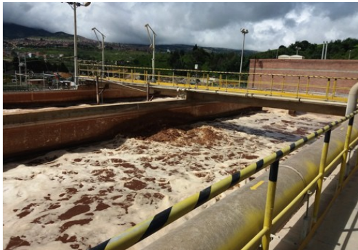
Ilustración 66. Biorreactores. Fuente: Visita de inspección y vigilancia del 30 de junio de 2017.
