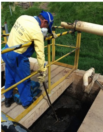
Ilustración 63. Remoción manual del sobrenadante en el proceso de coagulación/floculación. Fuente: Visita de inspección y vigilancia del 30 de junio de 2017.
