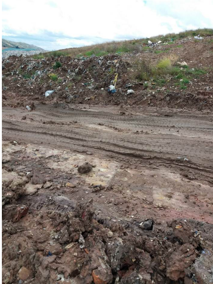
Ilustración 12. Ondulaciones en la vía. Fuente: Visita de inspección y vigilancia del 09 de agosto de 2017
