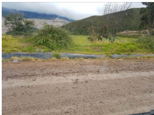
Ilustración 58. Canal para el control de escorrentía, tramo en geomembrana. Fuente: Visita de inspección y vigilancia del 06 de julio de 2017
