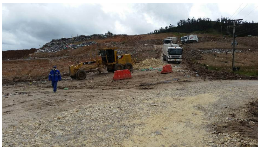
Ilustración 16. Pajarita en labores de adecuación de vías. Fuente: Visita de inspección y vigilancia del 11 de agosto de 2017
