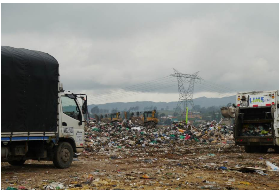
Ilustración 25. Frente de trabajo en Zona VIII. Fuente: Visita de inspección y vigilancia del 08 de mayo de 2017
