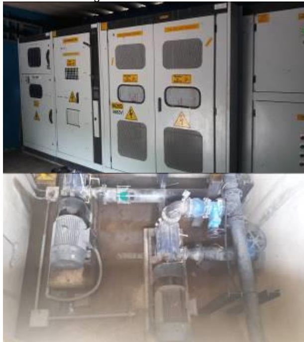
Imagen 6 Estación de Bombeo
