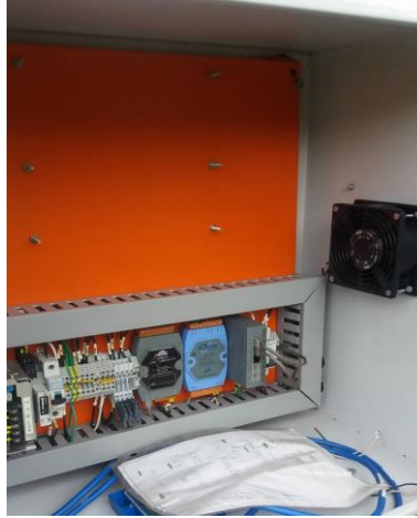
Imagen 30. Caseta del macromedidor dañado.
