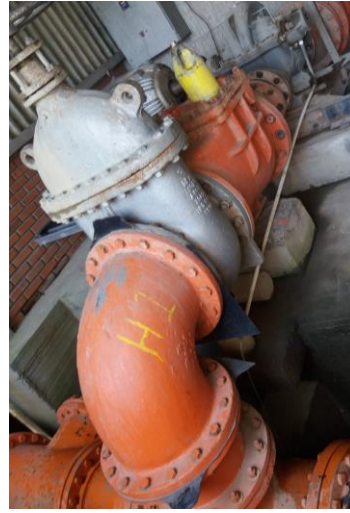
b) Estación de bombeo No. 3
