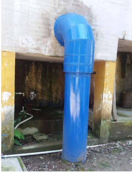
a) Tubería de entrada a la PTAP
