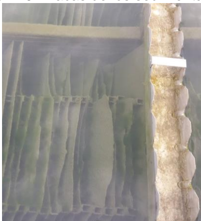
Imagen 29. Placas de los sedimentadores.
