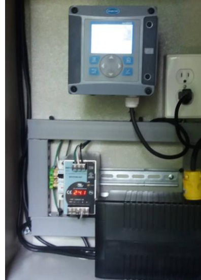
b) Instrumento de macromedición a la entrada de la PTAP.
