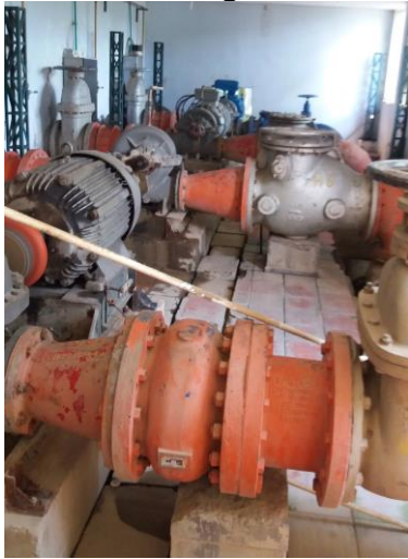
a) Estación de bombeo No. 2
