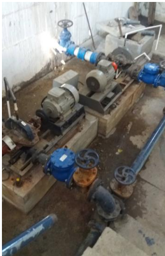
Imagen 37. Estación de bombeo Robertulio Lara.
