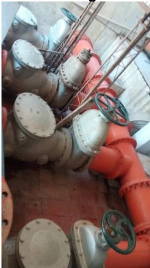
a) Estación de bombeo No. 2
