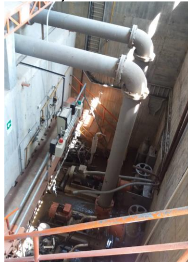
b) Estación de bombeo No. 3
