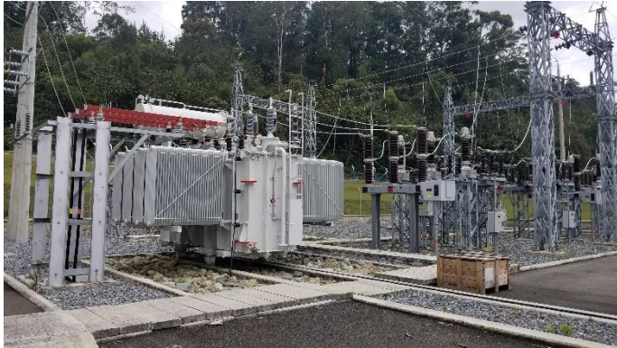
Subestación de energía
