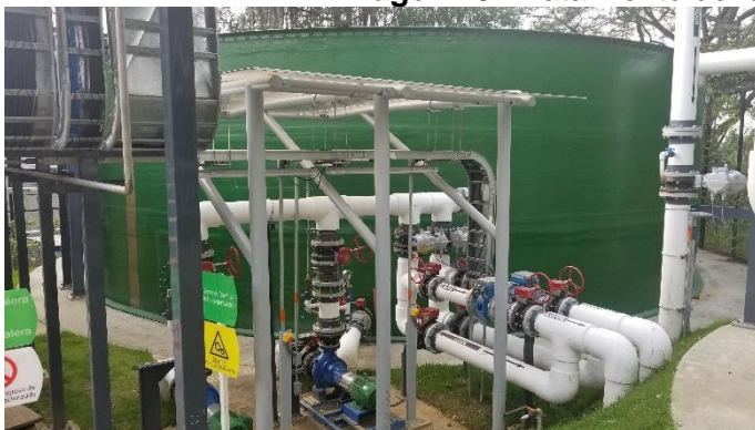
Tanque y bombas de homogenización
