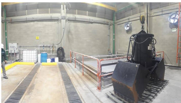
Trampa grasas - ingreso agua residual
