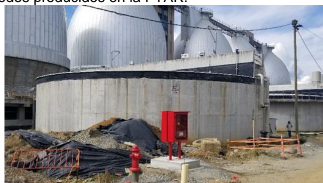
Tanque de espesamiento
