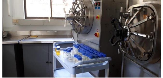
Lavado y esterilización
