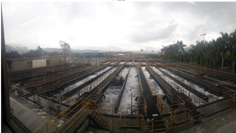
Tanques de aireación, sedimentadores secundarios Fuente: Visita SSPD
