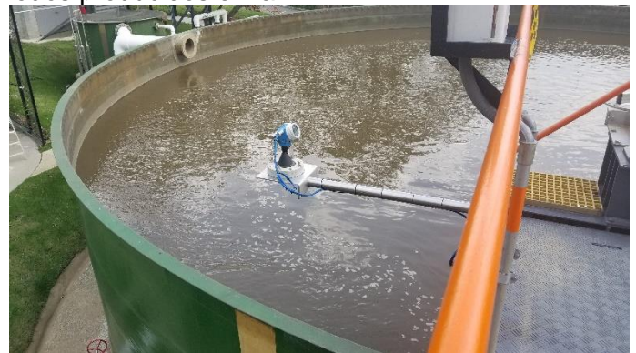
Tanque de homogenización
