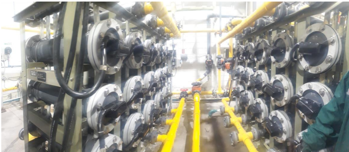
Modulo tratamiento de olores
