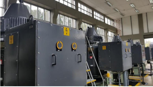
Sistema de bombeo
