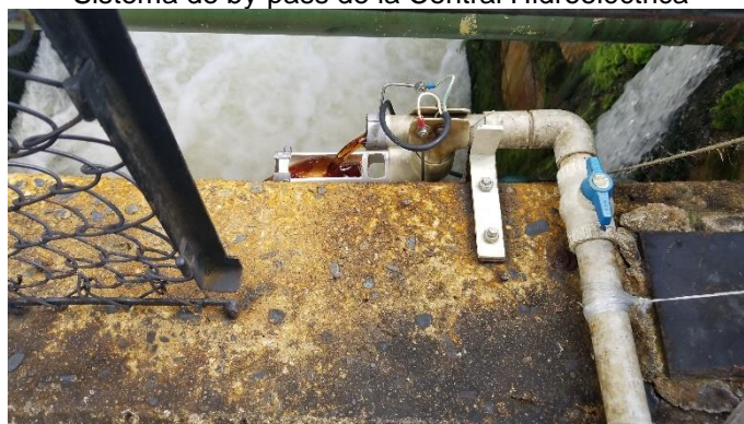
Punto de aplicación de coagulante
