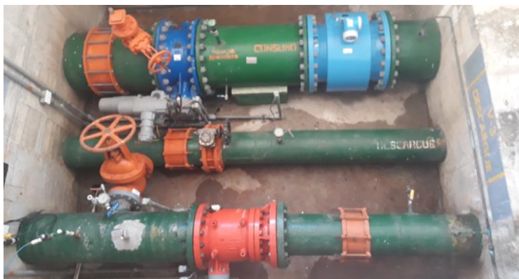
Tuberías de entrada y salida del tanque
