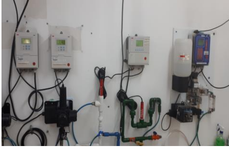
Medición parámetros en línea
