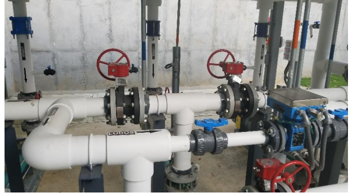
Sistema de bombeo a preespesado
