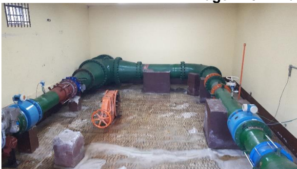
Tubería derivación del caudal captado
