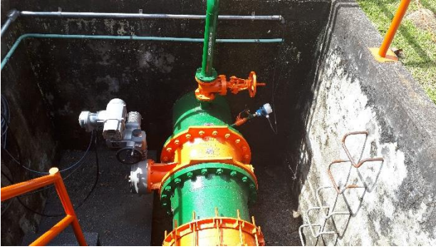
Macromedición en entrada a PTAP
