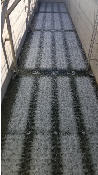
Tanque de aireación (En pruebas)
