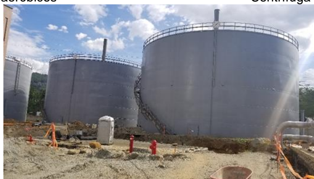
Tanques de almacenamiento de biogás
