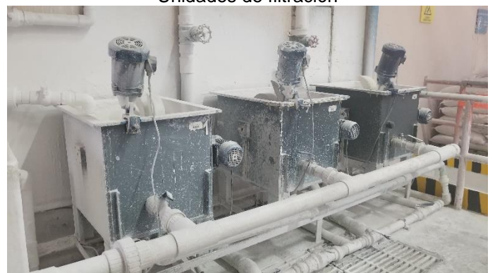
Sistema de dosificación de cal
