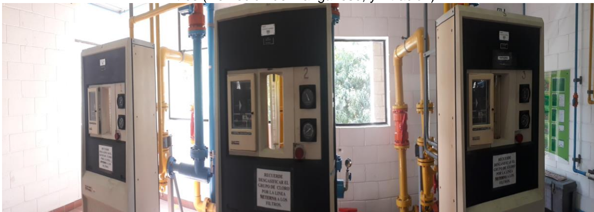
Dosificadores cloro gaseoso
