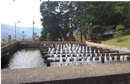
Torre de aireación
