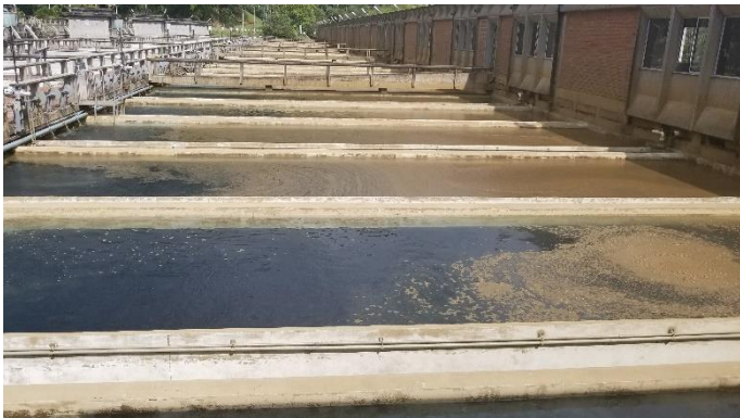
Unidades de filtración
