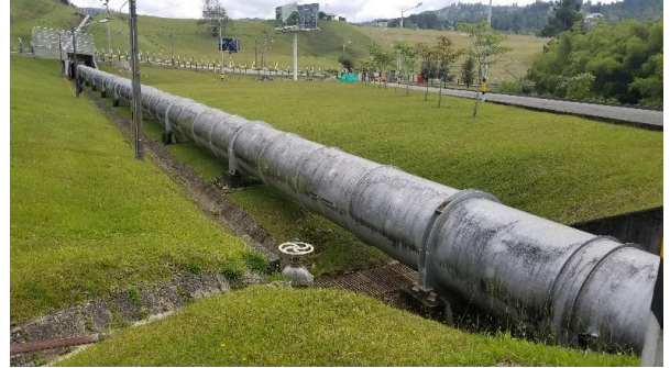
Tubería de aducción
