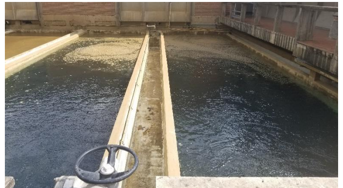
Unidades de filtración
