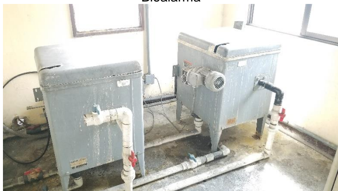
Sistema de dosificación de coagulante
