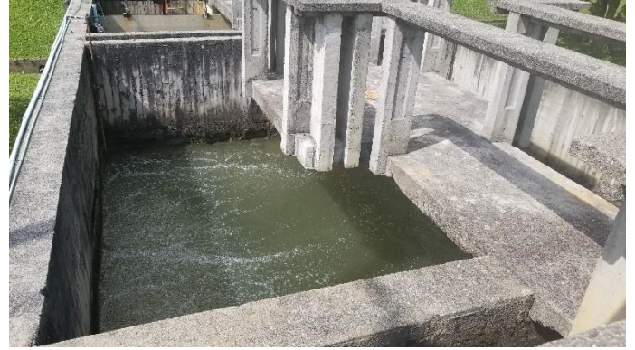
Cámara de reparto
