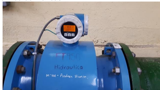
Macromedición caudal captado
