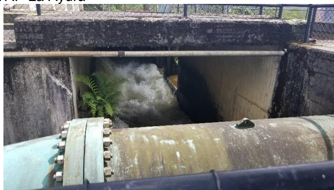
Sistema de by-pass de la Central Hidroeléctrica
