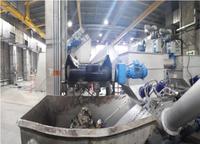
Sistema captación de basuras cribado grueso
