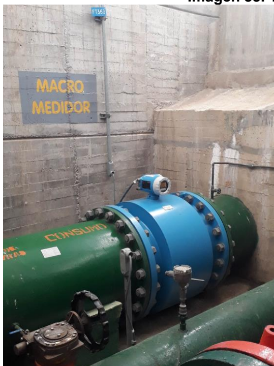
Macromedidor a la salida del tanque
