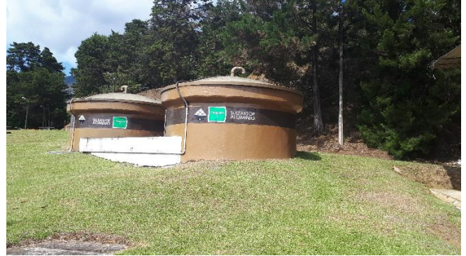
Almacenamiento de coagulante
