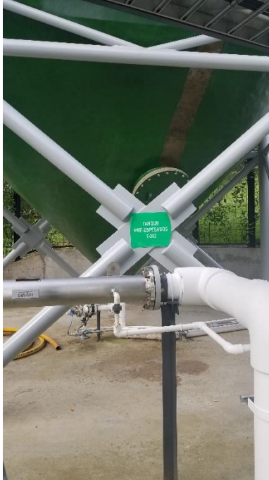
Tanque de preespesado
