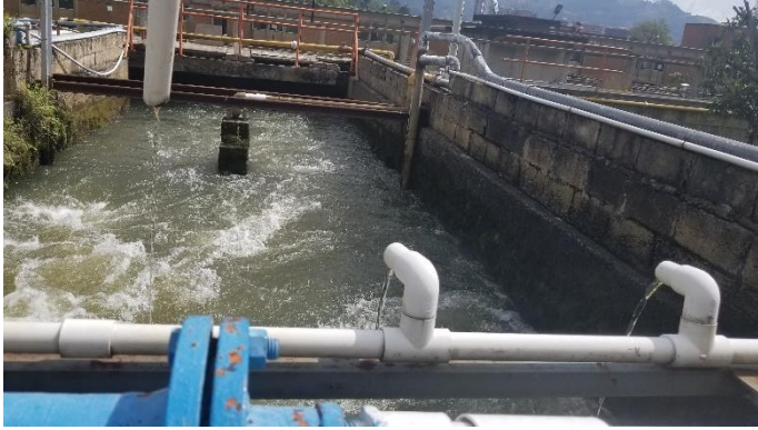
Cámara de entrada y punto de aplicación de polímero
