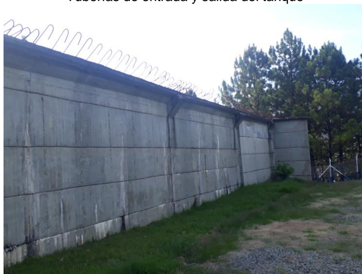
Vista lateral tanque Fuente: Visita SSPD
