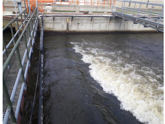
Resalto hidráulico y dosificación de Coagulante
