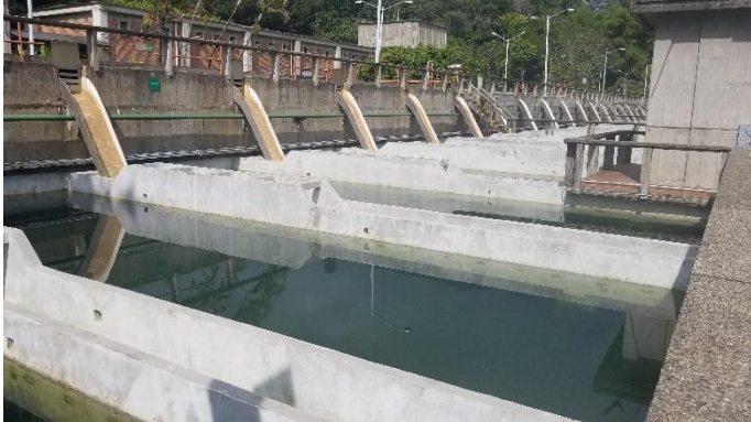
Unidades de floculación / sedimentación
