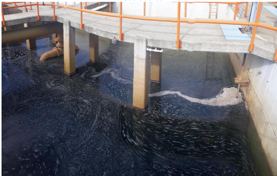
Filtros (Remoción de manganeso, y filtración)
