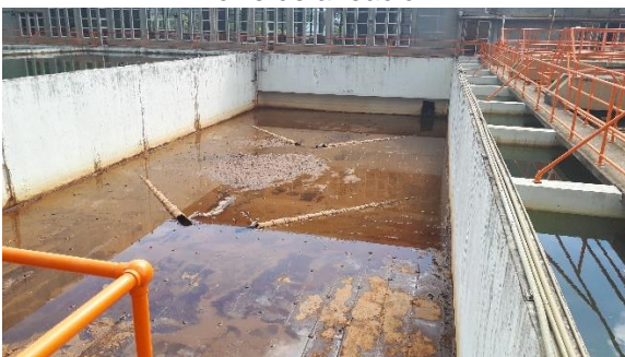
Tanque de recirculación
