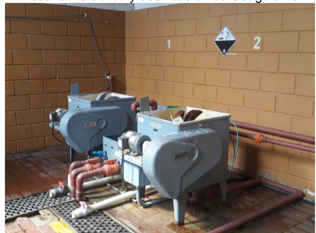
Dosificadores de Sulfato
