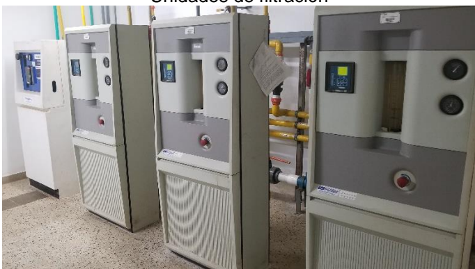
Sistema de dosificación de cloro
