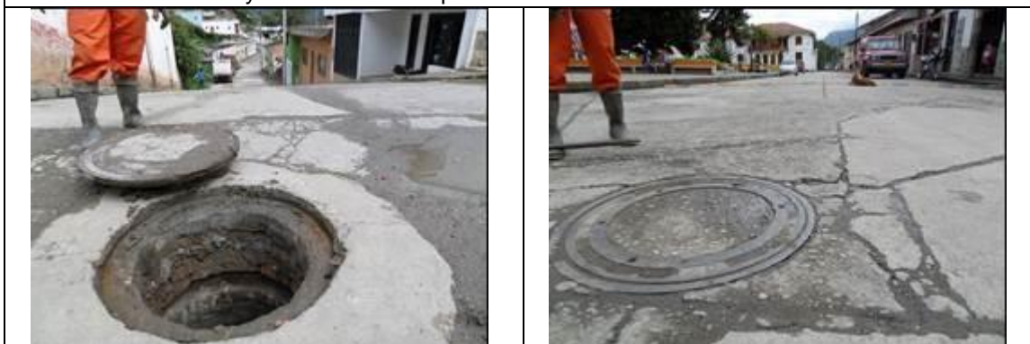
Fotos 24 y 25. Pozos de inspección municipio de Fômeque
