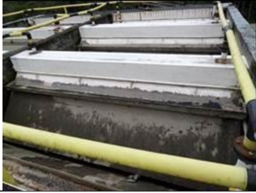
Foto 32. La mitad de la estructura del reactor se encontraba fuera de servicio
