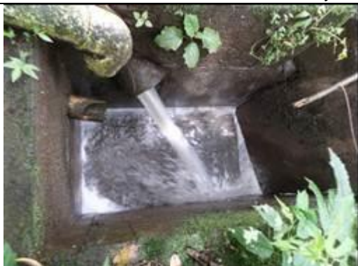
Foto 38. Estructura de descarga de la PTAR
