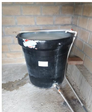
Figura 16. Dosificación de cloro
