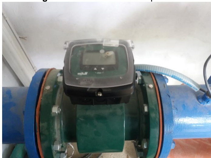
Figura 15. Macromedidor en pozo 13
