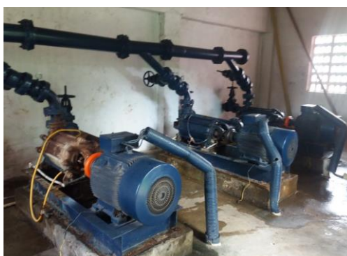
Figura 18 Estación de bombeo
