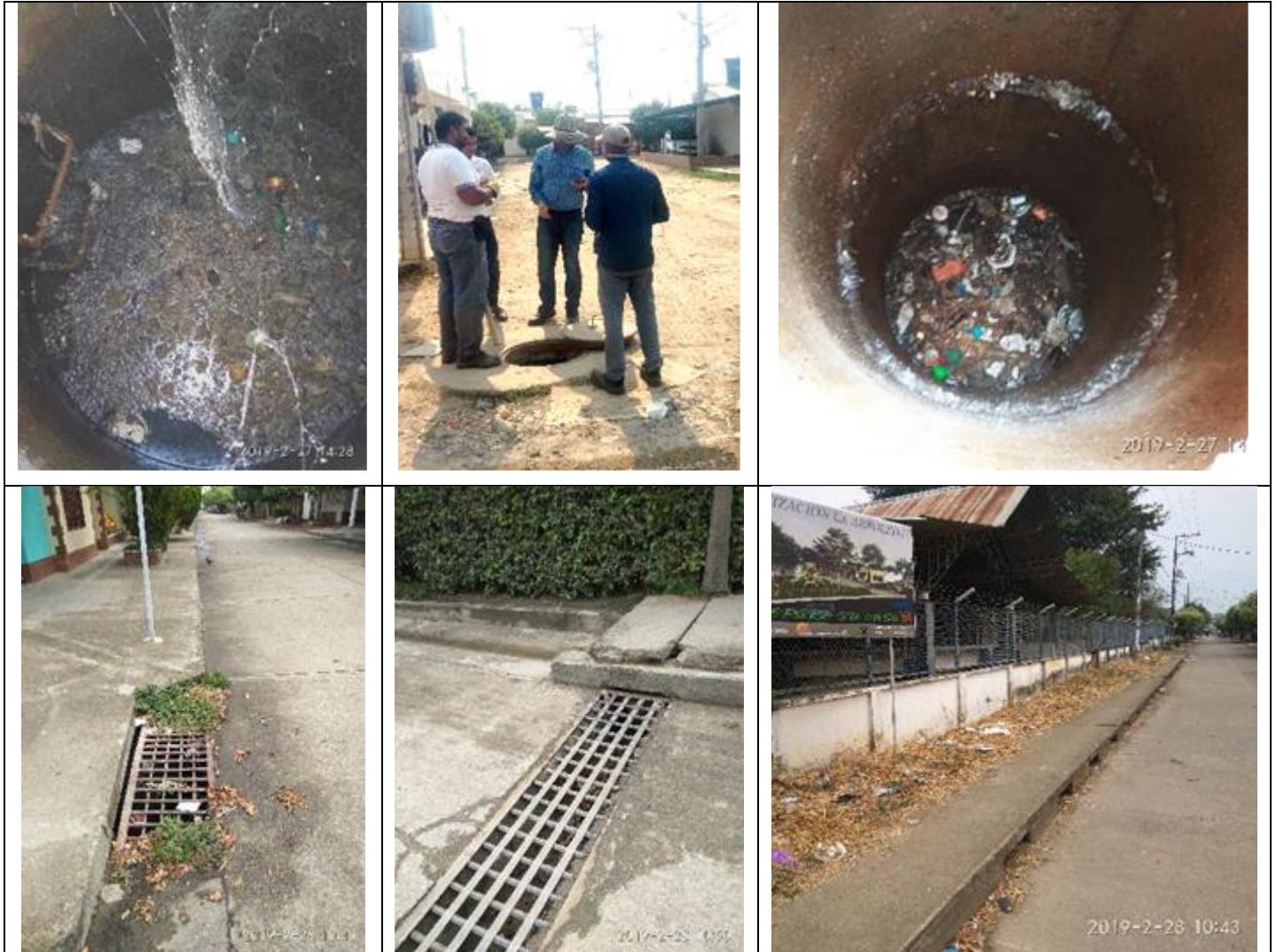
Imagen 17 Pozos de inspección y sumideros de aguas lluvias del casco urbano de San Martín, operando en condiciones normales.
