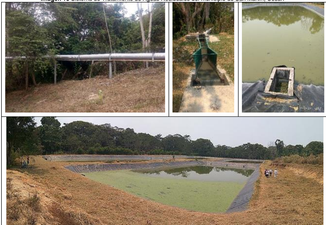
Imagen 18 Sistema de Tratamiento de Aguas Residuales del municipio de San Martín, Cesar.
