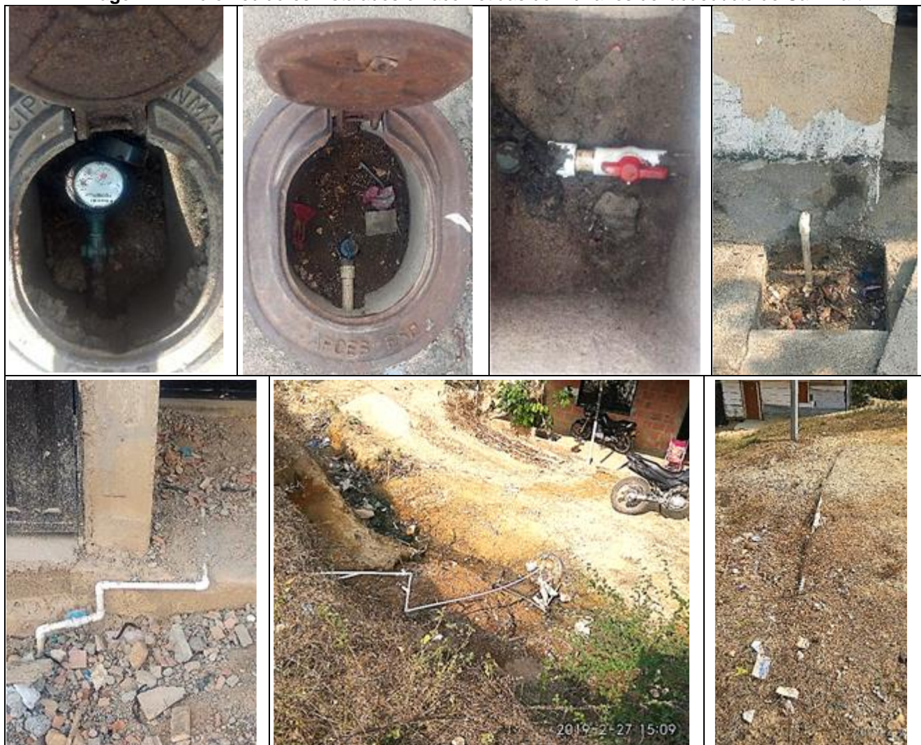
Imagen 14. Micromedidores instalados en acometidas domiciliarios del acueducto de San Martín.
