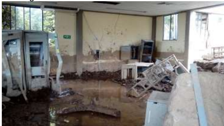
Imagen No. 2. Afectaciones a la Subestación Junín 2017
