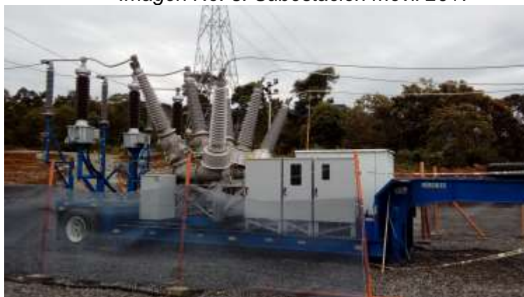
Imagen No. 3. Subestación móvil 2017
