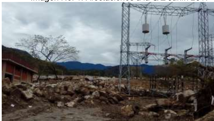
Imagen No. 1. Afectaciones a la S/E Junín 2017
