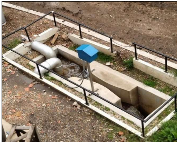
Imagen 10. Pretratamiento compacto (izquierda) y malla canal de reserva (derecha)
