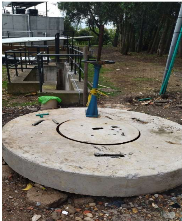
Imagen 1. Ingreso de agua residual- Colector
