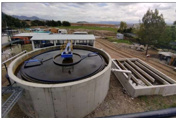
Imagen 7. Tanque Sedimentador con rastra (izquierda)
