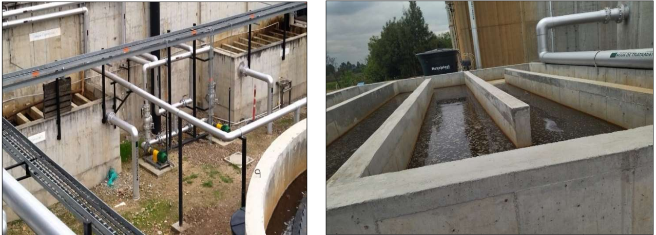
Imagen 8. Tanques desinfección 1 y 2 (Izquierda) y tanque desinfección 3 (Derecha)
