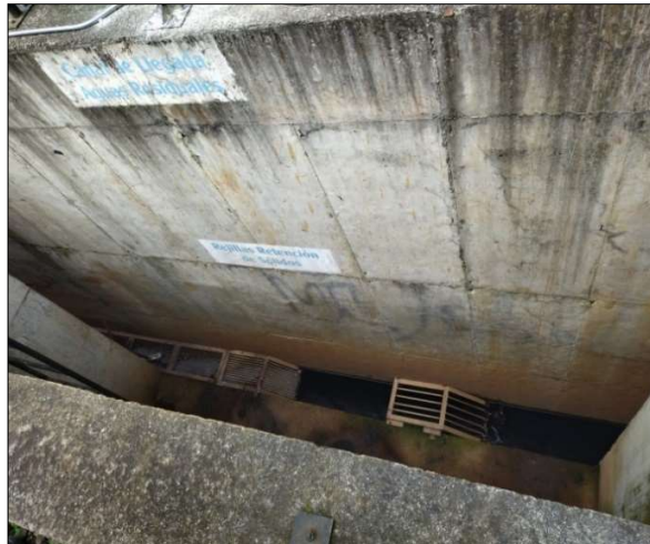
Imagen 2. Rejillas de Cribado gruesas y finas
