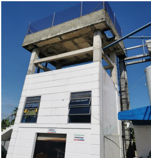
Infraestructura de PTAP y torre de aireación
