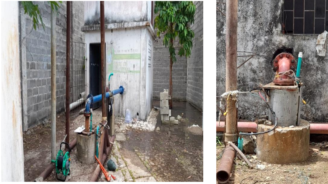
Imagen 1. Captación Pozos Subterráneos Tolú.
