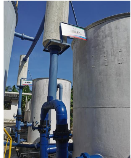
Torre de aireación y filtros
