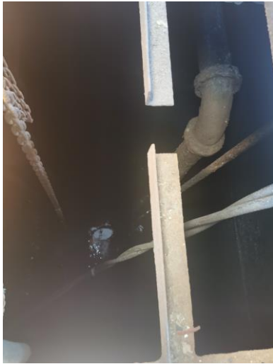
Estación de bombeo
