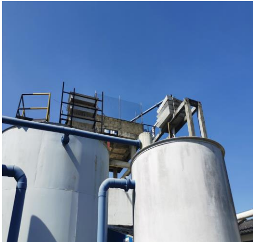
Torre de aireación y filtros
