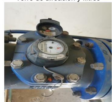
Macromedidor a la salida de la PTAP
