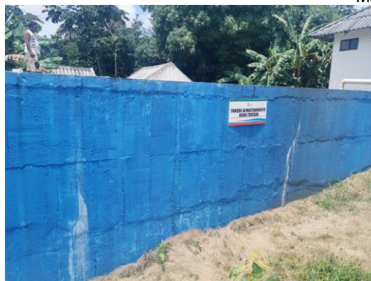
Tanque de almacenamiento Villeros
