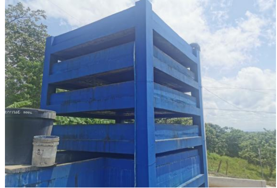
Torre de aireación
