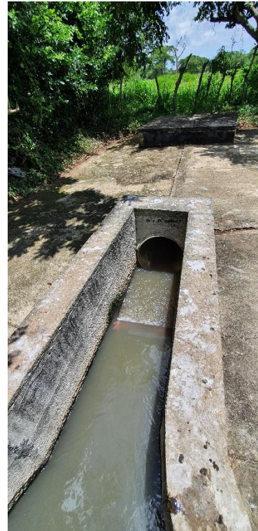
Entrada al tren de lagunas
