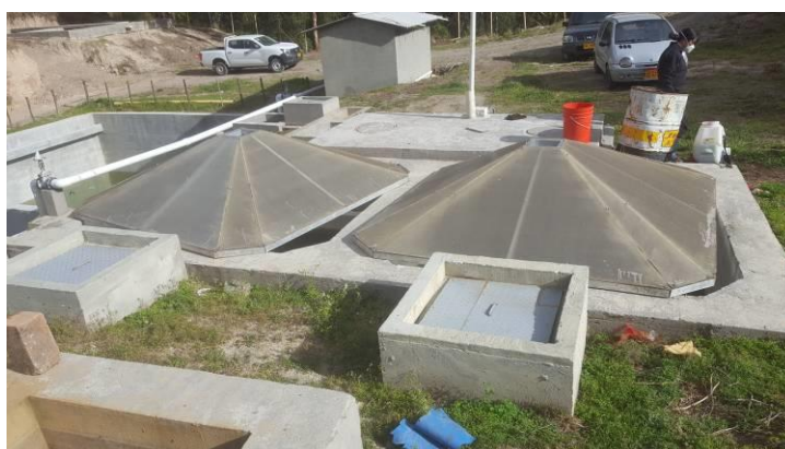
Foto 60. Planta de tratamiento de lixiviados
