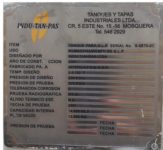
Figura 7. Placa de Identificación del tanque estacionario utilizado para el almacenamiento de GLP
