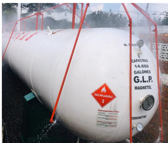
Figura 5. Red contra incendios INTERGAS S.A. E.S.P.
