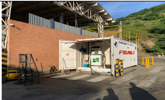
Zona de suministro de combustible
