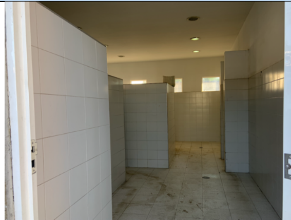
Instalaciones sanitarias con baño fuera de servicio
