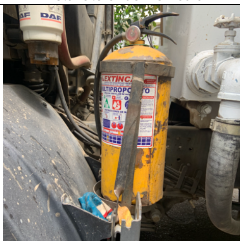
Equipo para atención de incendios
