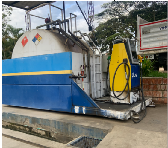
Área de suministro de combustible
