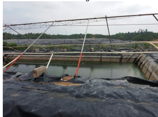
Piscina de lixiviados
