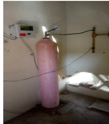
Dosificación de Cloro gaseoso fuera de funcionamiento
