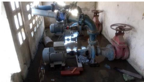
Fotografía No. 14 Bombas de distribución
