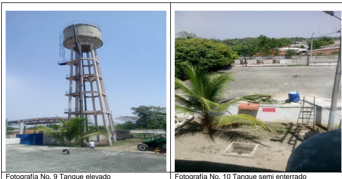
Fotografía No. 9 Tanque elevado
